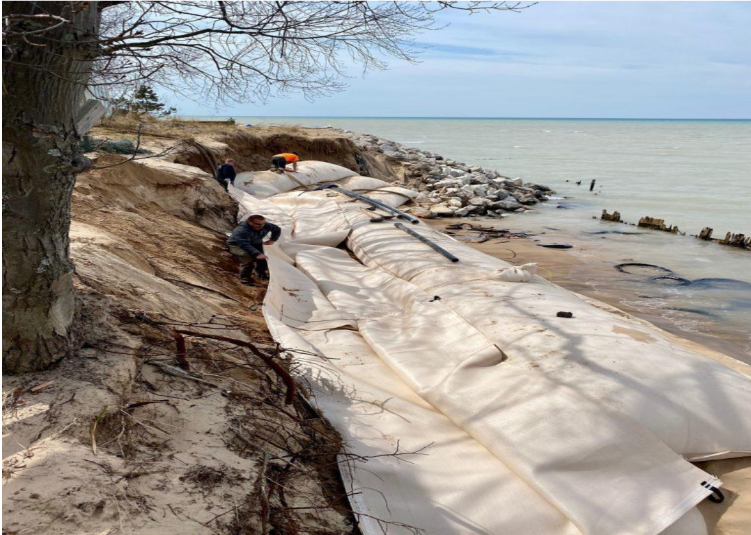
Εικόνα 6.30 Γεώσακοι για την προστασία της ακτογραμμής
