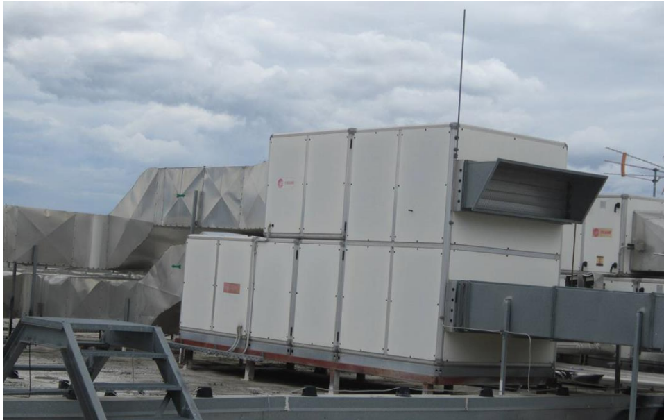
Εικόνα 5.1 Κεντρική κλιματιστική μονάδα με εναλλάκτη αέρα-αέρα σε οροφή κτιρίου [6].
