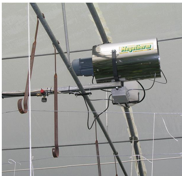
Εικόνα 20 : Σταθερός ψεκαστήρας (εκνεφωτήρας) θερμοκηπίου
