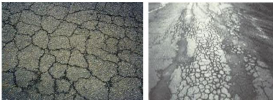
Εικόνα 19: Ρωγμές τύπου αλιγάτορα (17)
