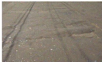
Εικόνα 26: Αυλακώσεις και κυματώσεις κατά πλάτος του οδοστρώματος (17)
