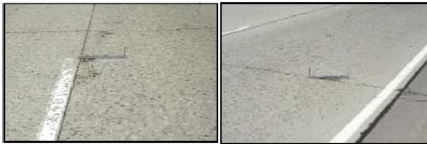
Εικόνα 38: Θρυμματισμός διαμήκους και εγκάρσιου αρμού (17)
