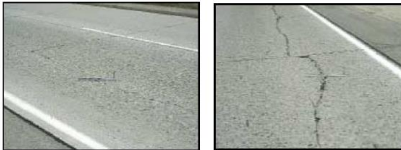
Εικόνα 40: Μέσης και υψηλής σοβαρότητας διαμήκειες ρωγμές (17)
