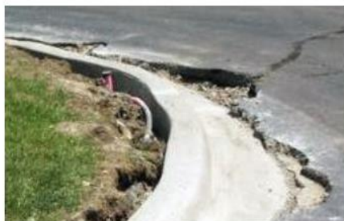
Εικόνα 20: Ρωγμές στα άκρα οδοστρώματος (17)
