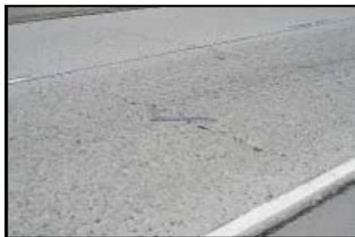
Εικόνα 41: Υψηλής σοβαρότητας εγκάρσιες ρωγμές (17)
