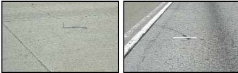
Εικόνα 39: Χαμηλής και μέσης σοβαρότητας γωνιακές ρωγμές (17)
