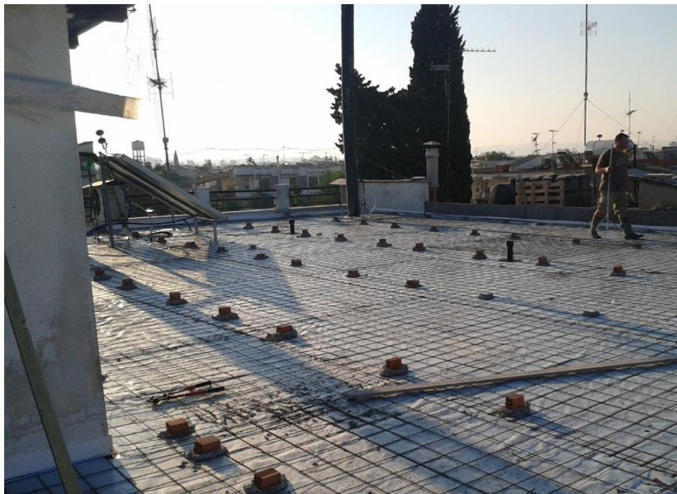
Εικόνα 4.15: Τοποθέτηση πολυεθυλενίου, οπλισμό με πλέγμα T92 και πηχάρισμα για τη δημιουργία ρύσεων.
