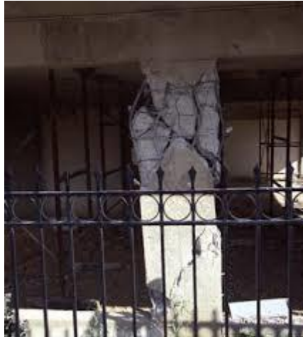
Εικ.6 Υποστύλωμα μετά από σεισμό. ( https://www.prooptiki-insurance.gr/ )
