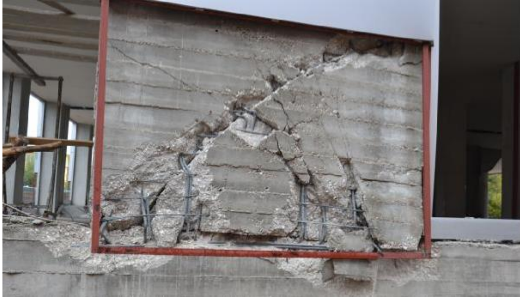
Εικ.8 Διατμητική βλάβη τοιχώματος ( http://www.eqclearinghouse.org )
