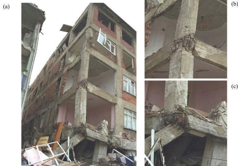
Εικ.9 Αστοχία κόμβων από σεισμό στην Τουρκία τον Αύγουστο του 1999, ( https://www.researchgate.net/figure/Partial-Building-Collapse-due-to-failure-of-beam-column-joints-in-the-Izmit-Turkey_fig1_324165100 )
