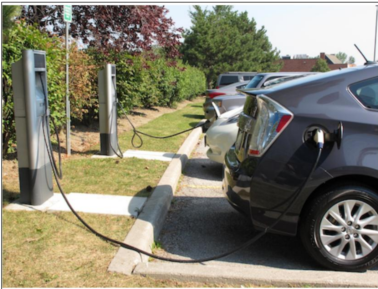
Εικόνα 2.2: Σταθμός φόρτισης υβριδικών οχημάτων (Πηγή: http://www.canadianautoreview.ca/reviews/2013-Toyota-Prius-Plug-in-Hybrid.html , 20/7/2020)
