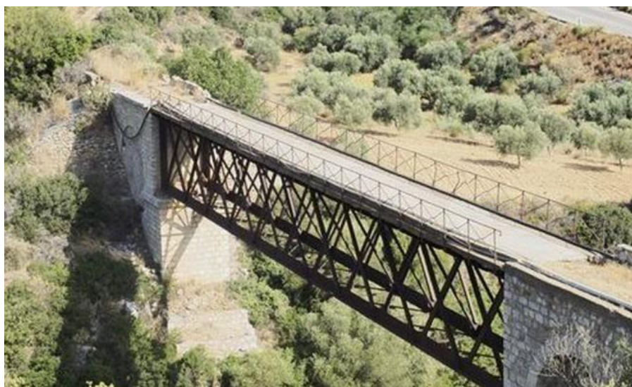
Εικόνα 1.3. Γέφυρα στο Στραβόρεμα, πριν τη Μονεμβασία, κατασκευάστηκε στις αρχές του 20ου αιώνα [link 3].
