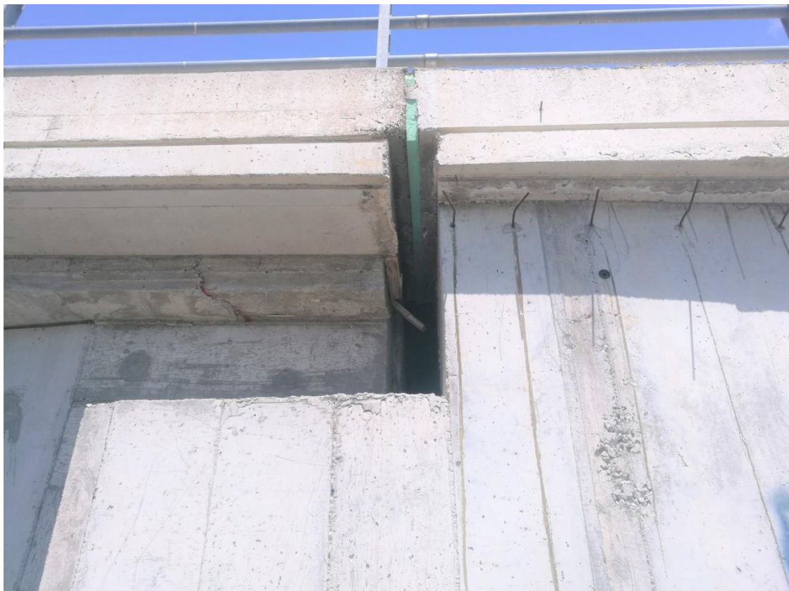
Φωτογραφία 5.11 Αρμός γέφυρας, κάτω μέρος.
