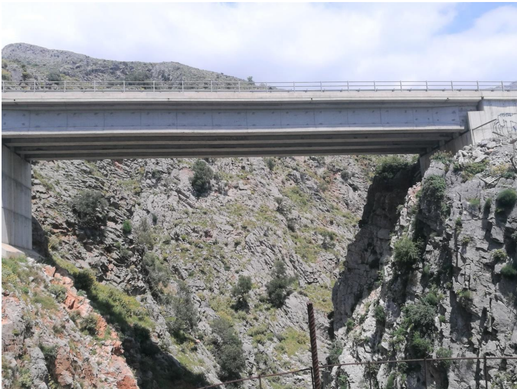
Φωτογραφία 5.5 Άνοιγμα χαράδρας κατάντη της γέφυρας.
