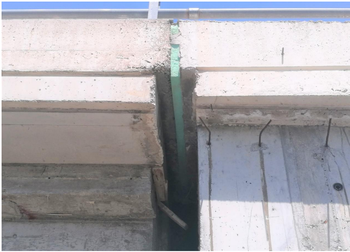
Φωτογραφία 5.12 Αρμός γέφυρας, κάτω μέρος.
