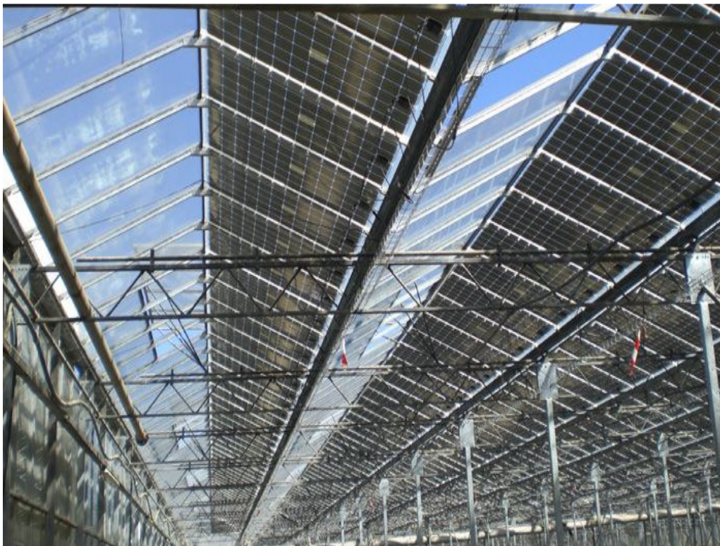
Εικόνα 3. Ενσωματωμένο φωτοβολταϊκό σύστημα ισχύος 2,5 MW, σε στέγη θερμοκηπίου στο Montelimar της Γαλλίας
