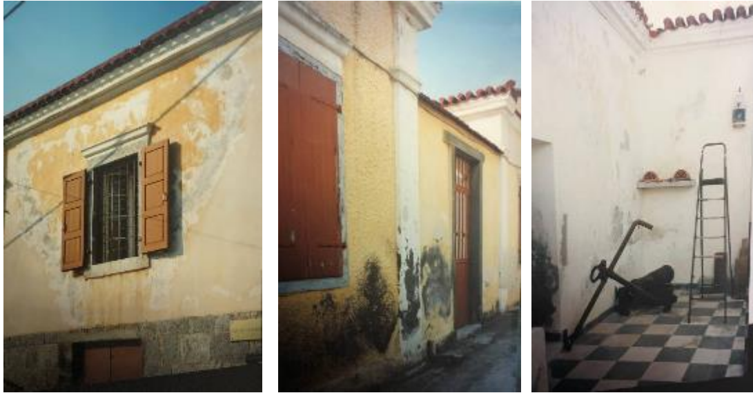
Εικόνες 23, 24, 25 – Σημάδια φθοράς στις εξωτερικές όψεις του κτιρίου του Μουσείου ©NIMF
