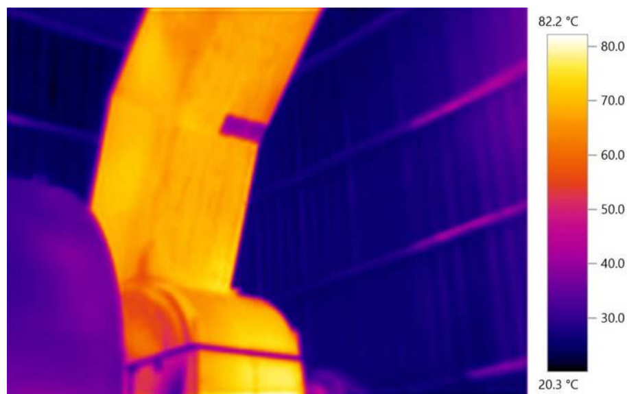
Εικόνα 2.8 : Κάτω τμήμα απαγωγής αερίων ξηραντηρίου
