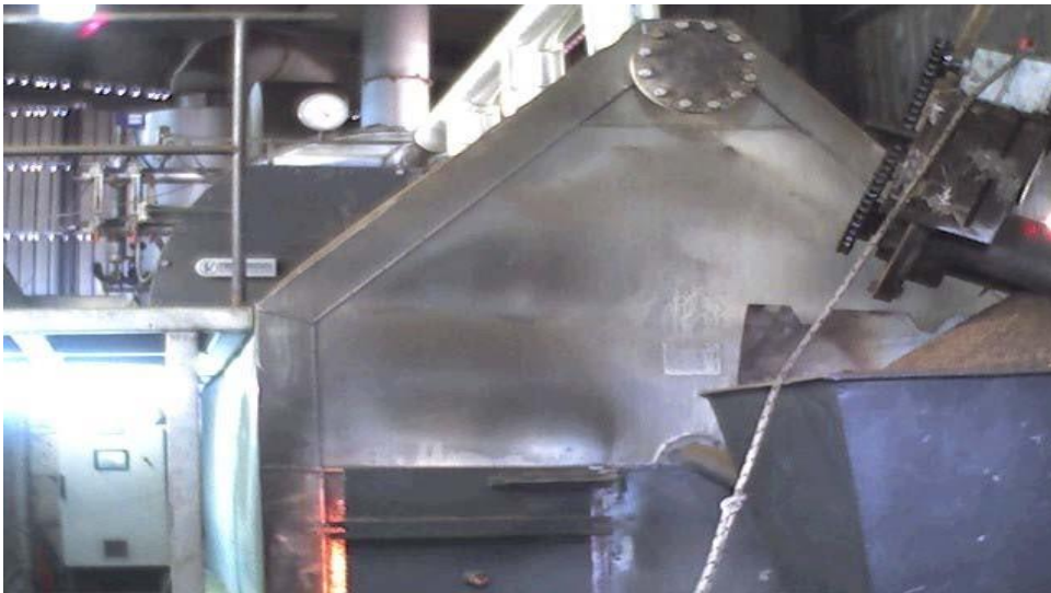
Εικόνα 1.11 :Εστία ατμοπαραγωγού με την προεστία σχήματος Δ
