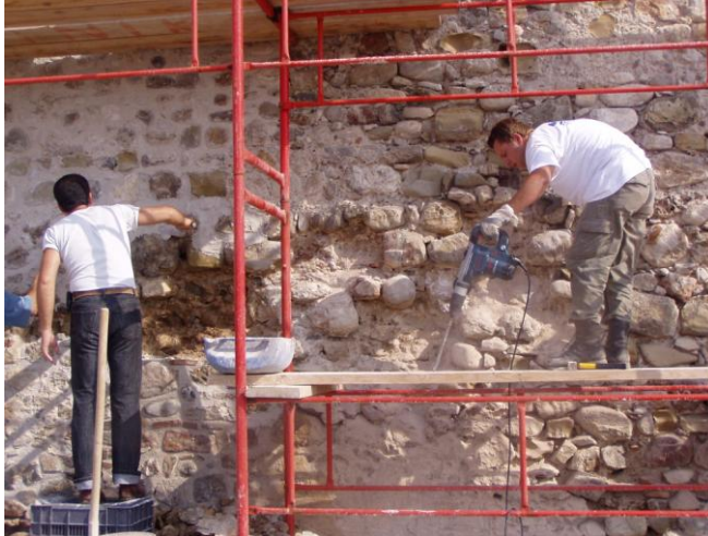
Εικόνα 92: εργασίες που πραγματοποιήθηκαν το 2006
