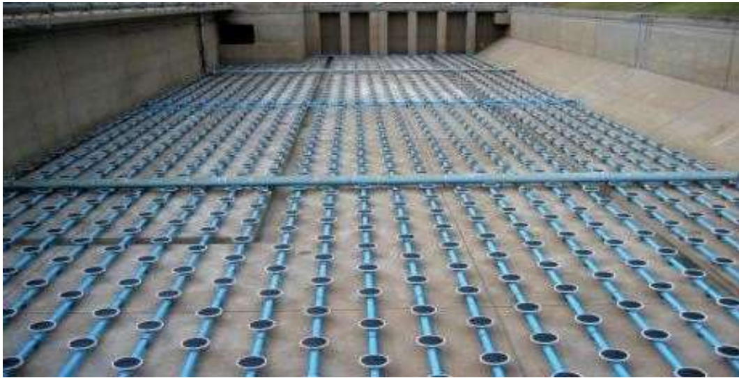
Εικόνα 2.10: Σύστημα αερισμού (β).
