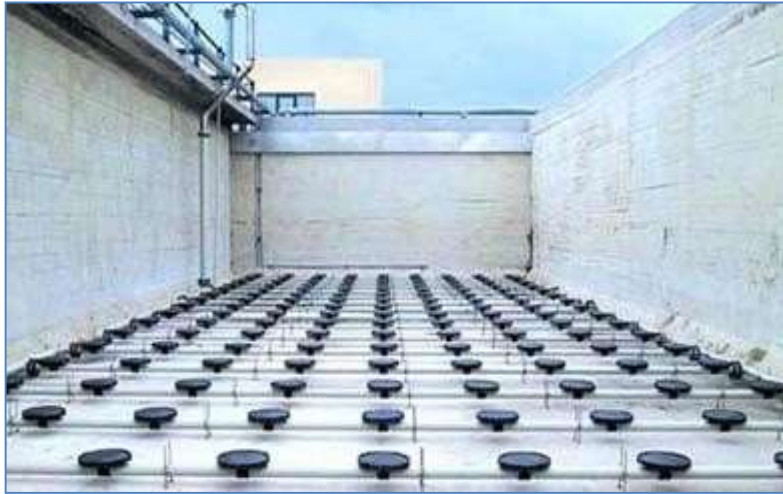
Εικόνα 1.11: Διαχυτές Αερισμού Λυμάτων Μεμβράνης.
