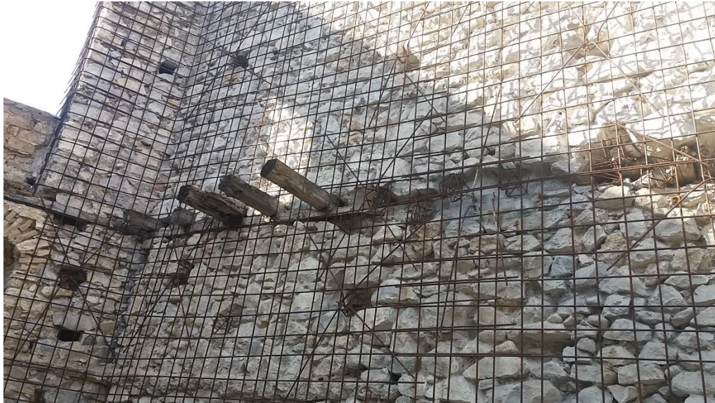
Εικόνα 3.17.: Εσωτερικός μεταλλικός μανδύας
