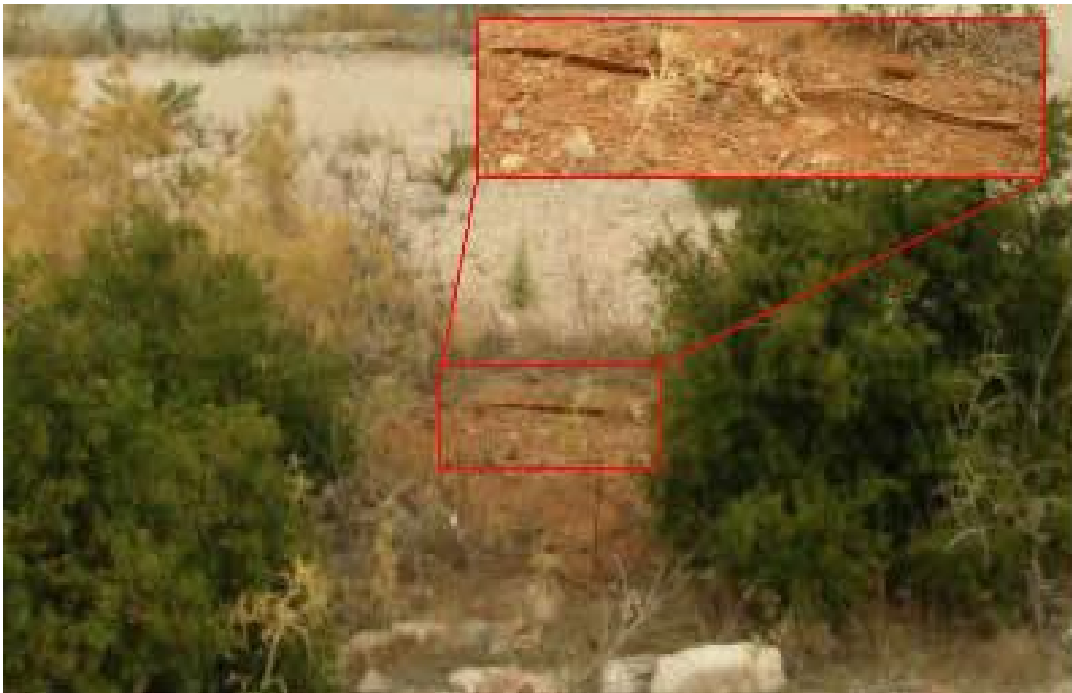
Εικόνα 3.2 Περιμετρικό ηλεκτρόδιο γείωσης σκεπασμένο με χώμα [16]
