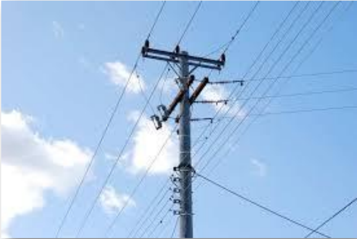
Εικόνα 6: Στύλος μέσης τάσης με μεικτή γραμμή μέση και χαμηλή
