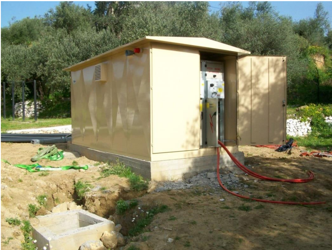
Εικόνα 16: Υπαίθριος Υποσταθμός μέσης τάσης
