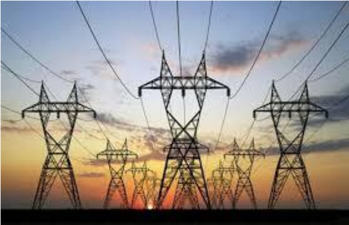
Εικόνα 4: Πυλώνες υψηλής τάσης
