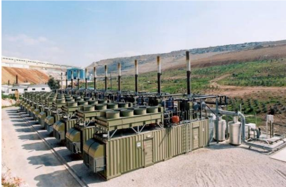
Εικόνα 12: Σταθμός παραγωγής βιοαερίου (Άνω Λιόσια, Αθήνα) [8]
