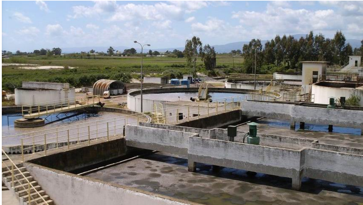
Εικόνα 7. Δεξαμενές τελικής καθίζησης της ΕΕΛ Καλαμάτας.
