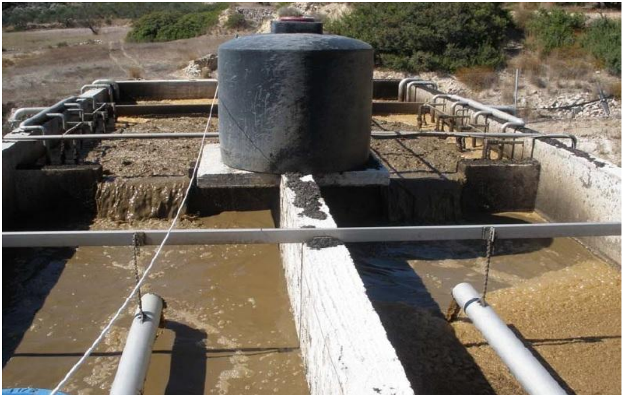
Εικόνα 2. Οριζόντιος αεριζόμενος αμμοσυλλέκτης – λιποσυλλέκτης εγκαταστάσεως Μήλου 8 .
