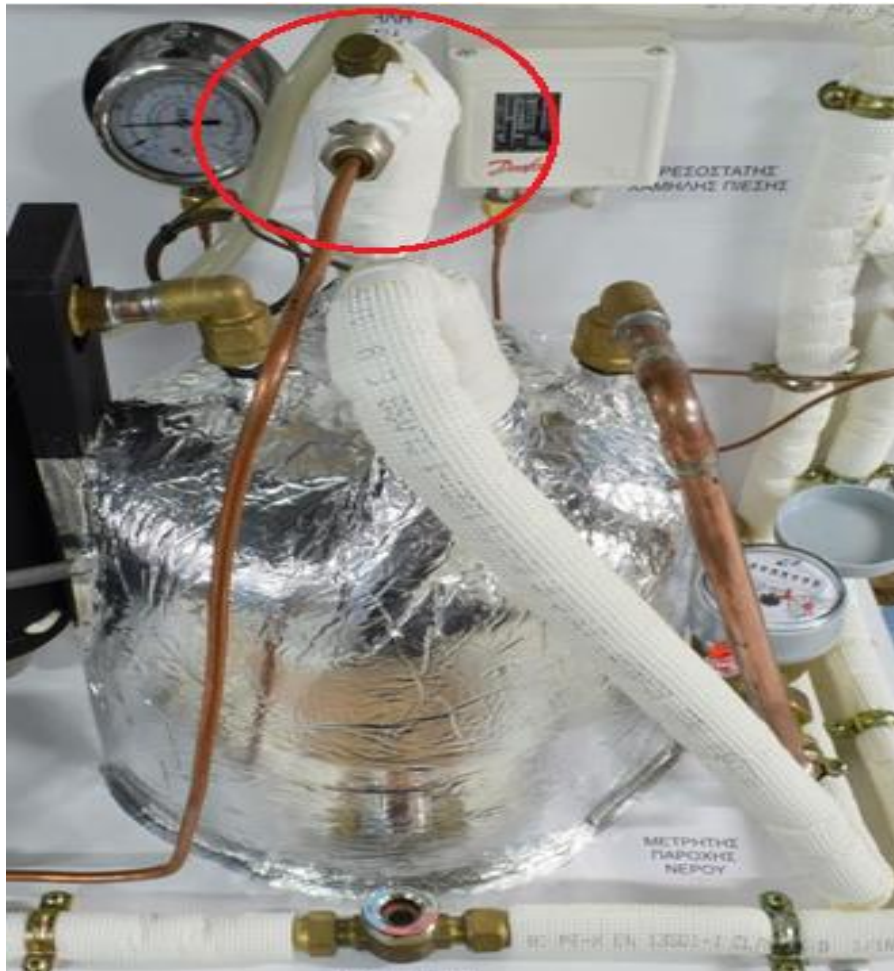
ΕΙΚΟΝΑ 6.7 Εκτονωτική διάταξη πριν τον εξατμιστή νερού
