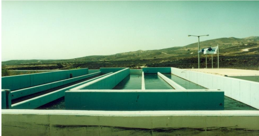
Εικόνα 1.7: Δεξαμενή χλωρίωσης (εξωτερική, με μαιανδρική διαδρομή)
