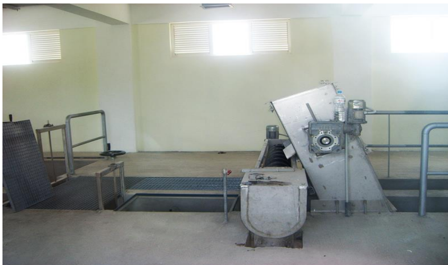
Εικόνα 1.2:Εσχάρωση και εξάμωση
