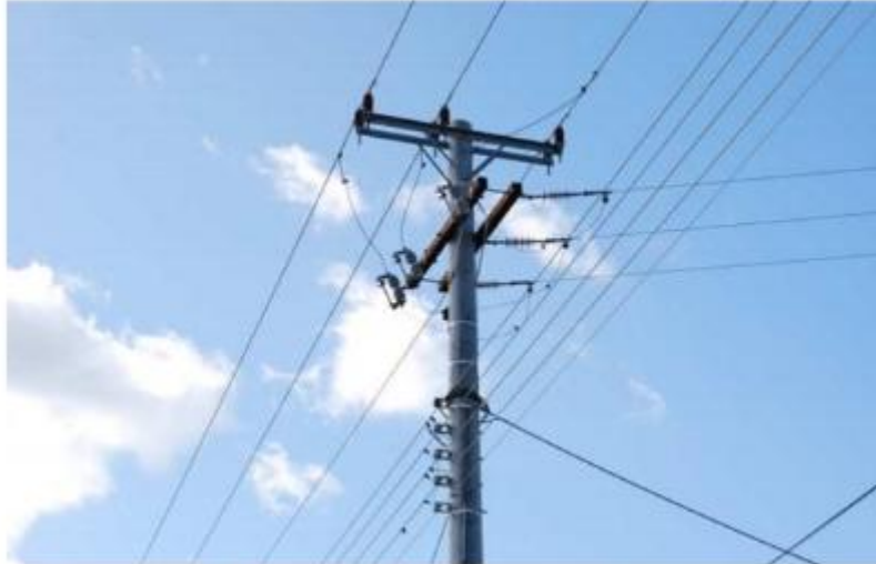
Εικόνα 20: Πυλώνας μέσης τάσης
