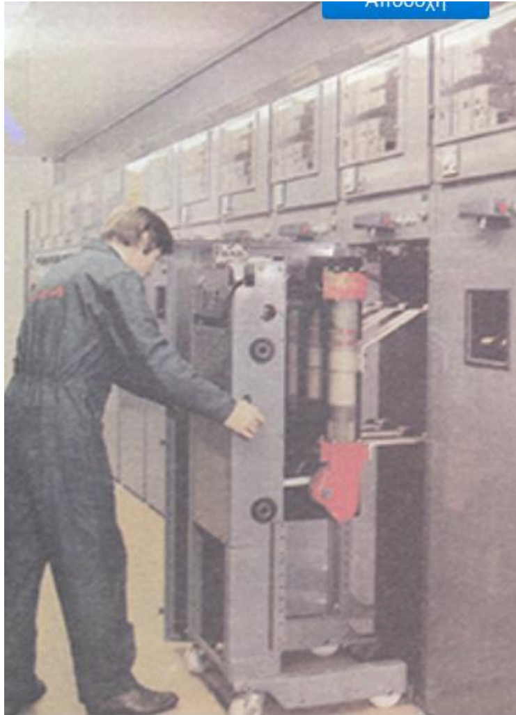
Εικόνα 36: Διακόπτης ισχύος επί φορείου
