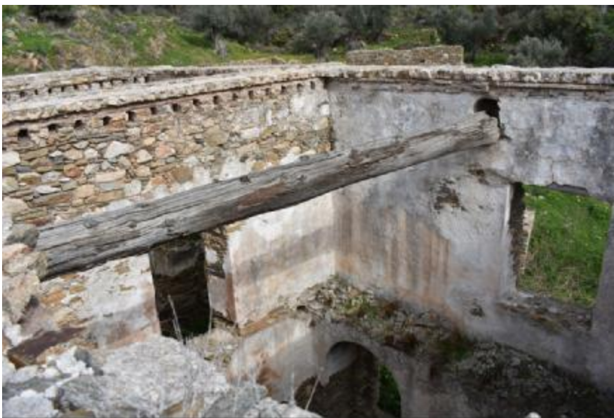
Εικόνα 15: Φωτογραφία επάνω ορόφου βορειοανατολικών δωματίων κεντρικού κτιρίου (κατεστραμμένη οροφή).
