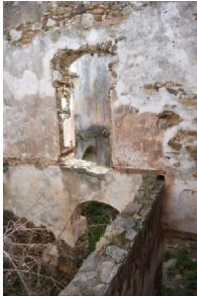
Εικόνα 14: Φωτογραφία βορειοανατολικών δωματίων κεντρικού κτιρίου (κατεστραμμένο δάπεδο επάνω ορόφου βορειοανατολικής πλευράς).
