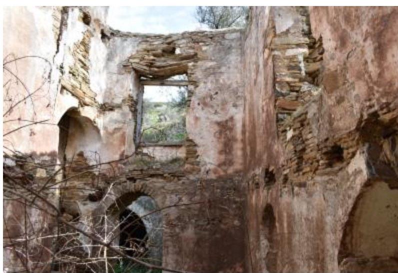
Εικόνα 8: Φωτογραφία ισογείου νοτιοανατολικού δωματίου κεντρικού κτιρίου (κατεστραμμένο δάπεδο επάνω ορόφου).
