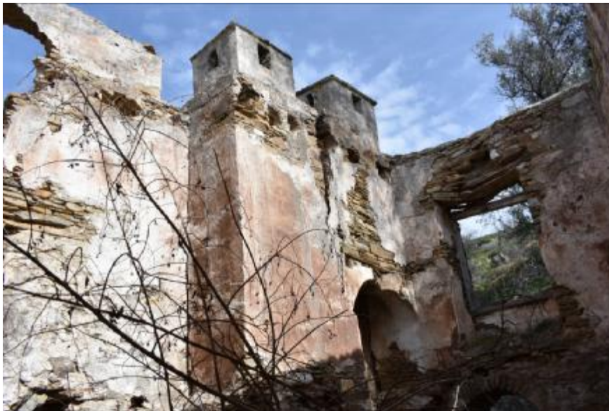
Εικόνα 9: Φωτογραφία ισογείου νοτιοανατολικού δωματίου κεντρικού κτιρίου (κατεστραμμένο δάπεδο επάνω ορόφου).
