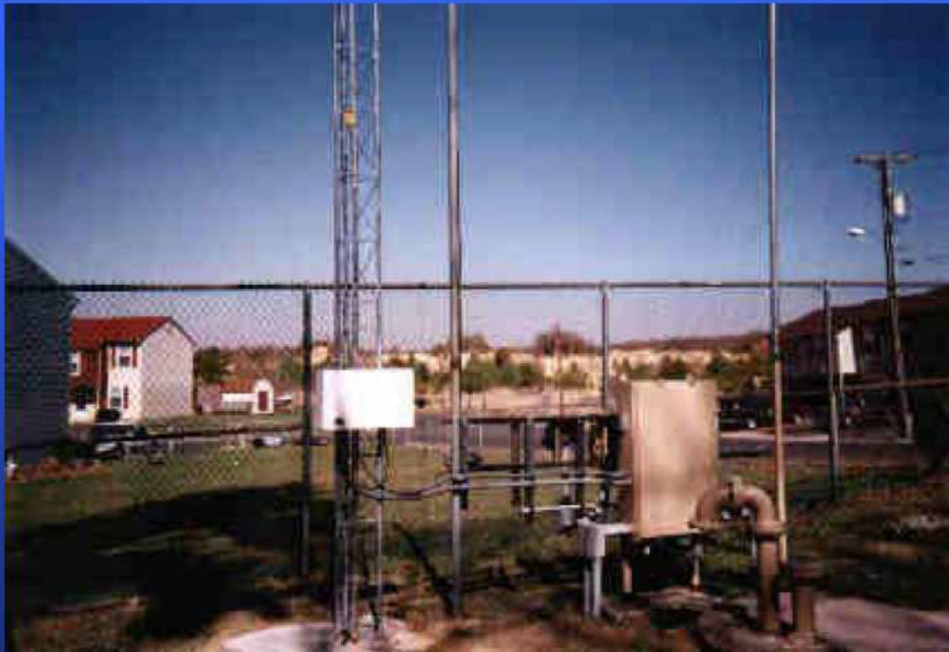
Εικόνα 11 - Εξωτερική Εγκατάσταση Συστήματος SCADA
