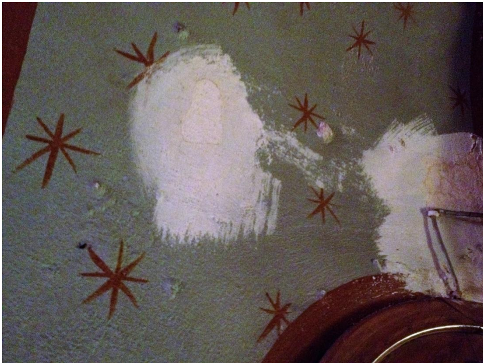
Εικόνα 24. Αλλοίωση τοιχοποιίας. Χρωματισμός με αστέρια που δεν αρμόζει στην ταυτότητα του ναού καθώς και επιδιόρθωση που δεν έχει ολοκληρωθεί.
