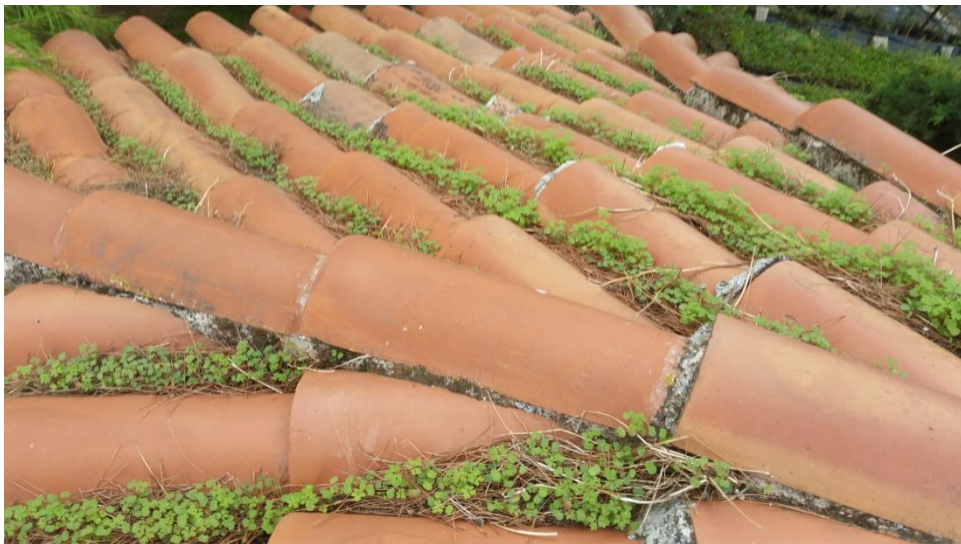
Εικόνα 26. Στέγη παλιού ναού. Βλάστηση ανάμεσα από τα κεραμίδια.
