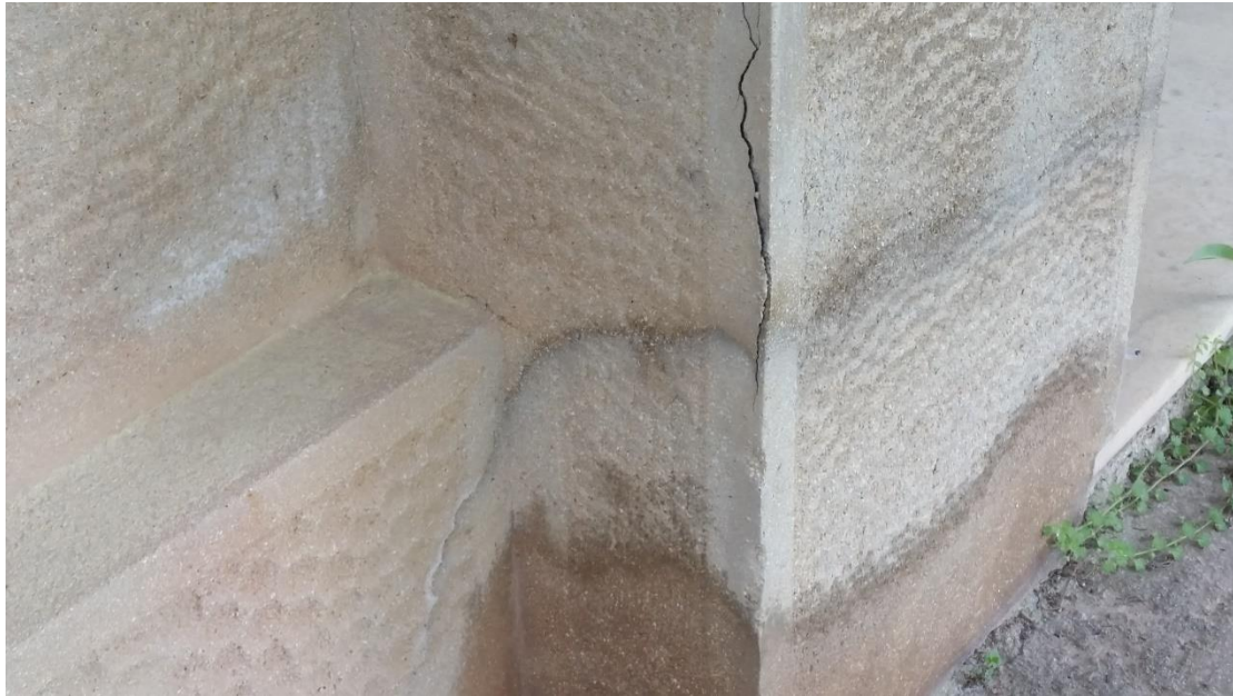
Εικόνα 29. Αλλοίωση τοιχοποιίας. Εμφανής αιτία για την συγκεκριμένη αλλοίωση είναι η κατερχόμενη υγρασία.
