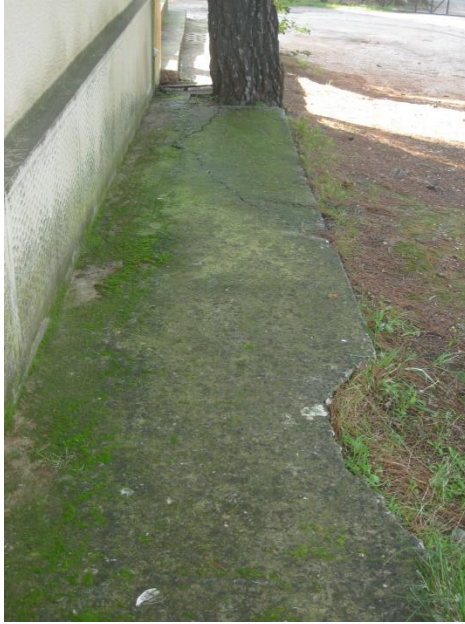
Εικόνα 36. Σπασμένο πεζοδρόμιο. Η αιτία για το σπάσιμο του τσιμέντου είναι η υγρασία καθώς και οι ρίζες των δέντρων.
