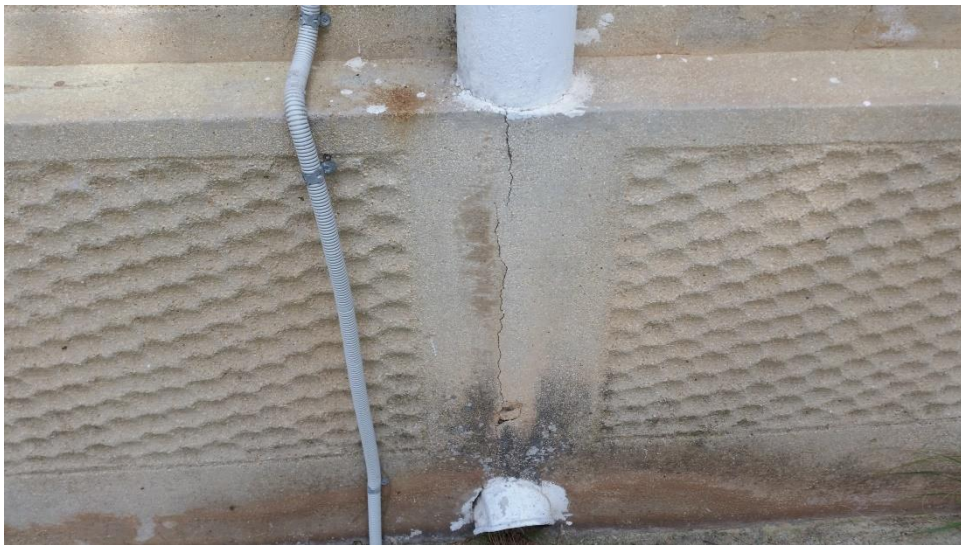
Εικόνα 28. Ρηγματώσεις. Στις εξωτερικές όψεις του ναού παρατηρούνται ρηγματώσεις, κυρίως με μικρό βάθος.
