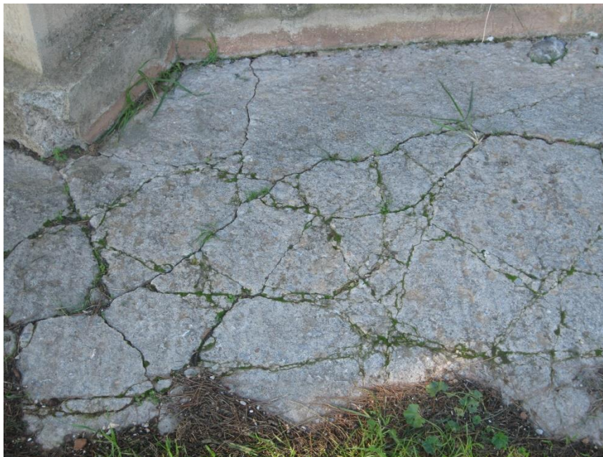
Εικόνα 35. Σπασμένο πεζοδρόμιο. Το πεζοδρόμιο βρίσκεται περιμετρικά του ναού. Η πρόταση της εργασίας συνιστά την αντικατάσταση του.
