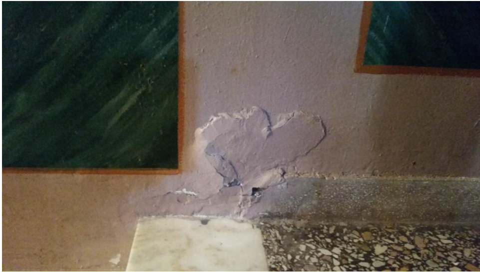
Εικόνα 19. Τοιχοποιία. Υπάρχει αλλοίωση της τοιχοποιίας στον ναό από την υγρασία και την αστοχία των χρωμάτων.
