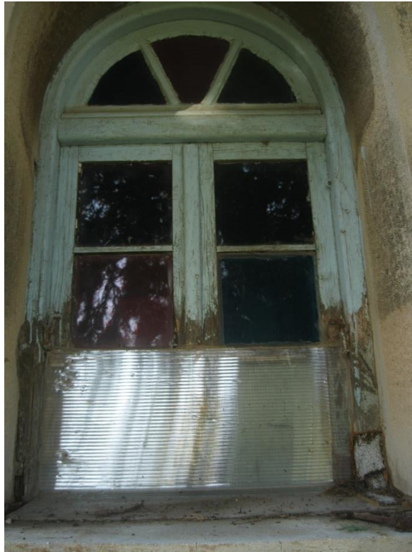
Εικόνα 34. Κούφωμα. Τα κουφώματα της εκκλησίας βρίσκονται όλα στην ίδια κατάσταση (σαπισμένα ξύλα) και η ολική αντικατάσταση τους κρίνεται απαραίτητη.
