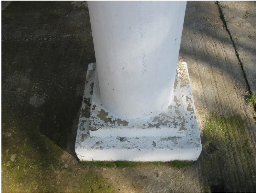
Εικόνα 32. Κίονες. Οι εξωτερικοί κίονες φέρουν αποφλοίωση του χρώματος.
