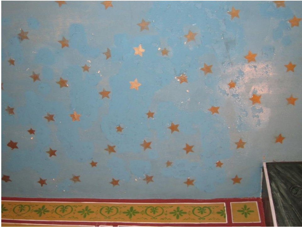
Εικόνα 25. Ταβάνι. Στο ταβάνι διακρίνονται χρωματισμοί και σχηματισμοί αστεριών που δεν ταιριάζει στον χαρακτήρα του ναού.
