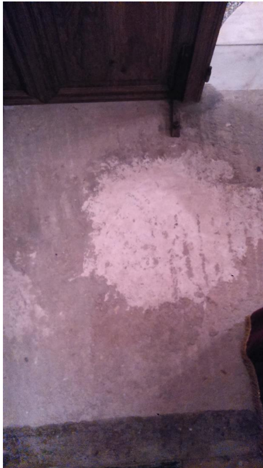
Εικόνα 20. Πάτωμα ιερού. Έχουν αποκολληθεί τα πλακάκια με αποτέλεσμα το σκυρόδεμα να είναι εμφανές.
