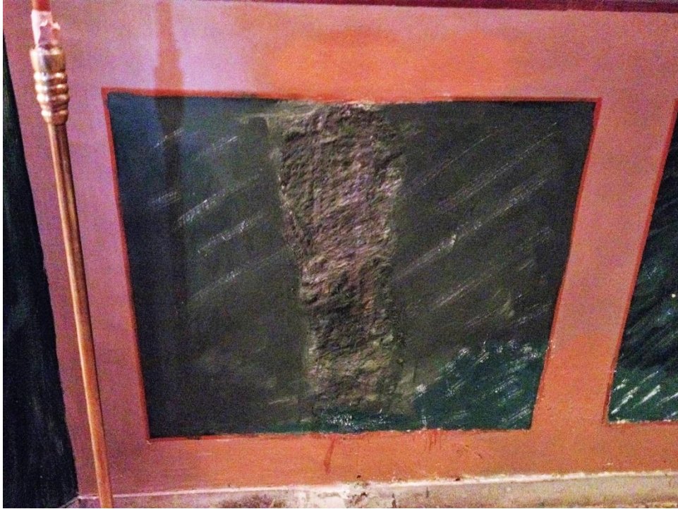
Εικόνα 23. Αλλοίωση τοιχοποιίας. Οι αλλοιώσεις στις τοιχοποιίες του ναού , είναι αποτέλεσμα της υγρασίας και της ανθρώπινης απροσεξίας.
