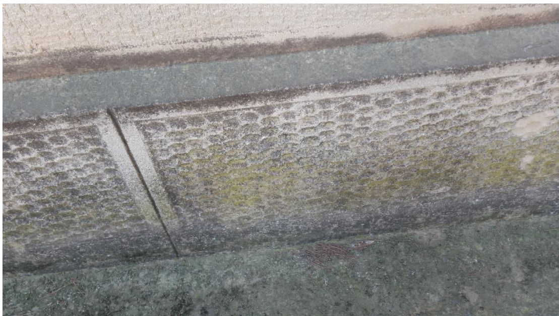
Εικόνα 30. Μαυρίλες στην τοιχοποιία. Οι μαυρίλες συχνά είναι αποτέλεσμα ρύπων και καθαρίζονται με υδροβολή.
