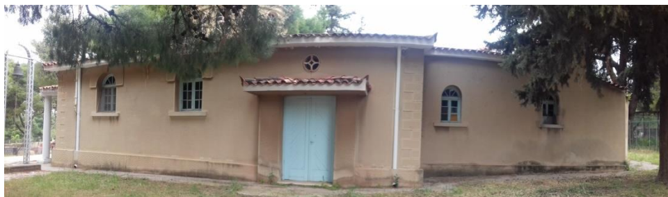
Εικόνα 10. Πανοραμική άποψη της νότιας όψης. Η νότια όψη, όπως και η βόρεια είναι οι μεγαλύτερες σε μήκος.
