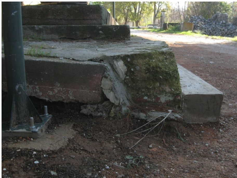
Εικόνα 33. Σκαλιά. Τα εξωτερικά σκαλιά έχουν καταστραφεί ολοκληρωτικά. Η πρόταση αναδιαμορφώνει τα σκαλοπάτια με πιο βολικά πατήματα και ρίχτια.
