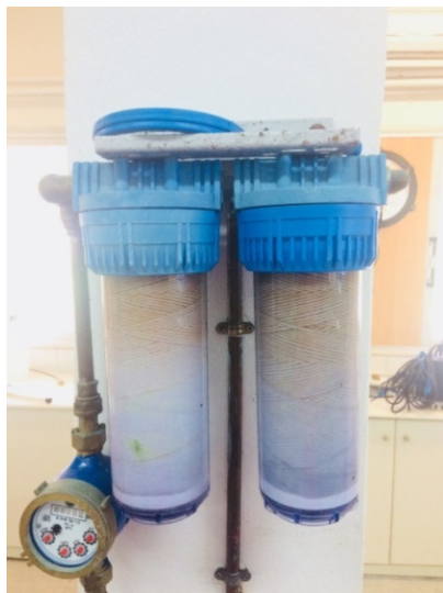
Εικόνα 11 Σημείο εισόδου του νέου νερού στο σύστημα. Από αριστερά προς τα δεξιά διακρίνονται: ροόμετρο, μηχανικό φίλτρο και φίλτρο ενεργού άνθρακα
