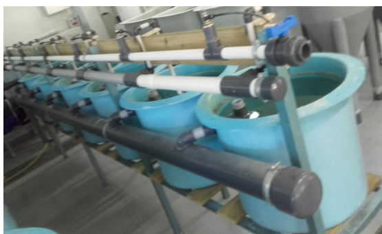
Εικόνα 15 Συστοιχία έξι δεξαμενών εκτροφής. Διακρίνονται από επάνω προς τα κάτω: δίκτυο αέρα, δίκτυο παροχής νερού, δίκτυο αποχέτευσης
