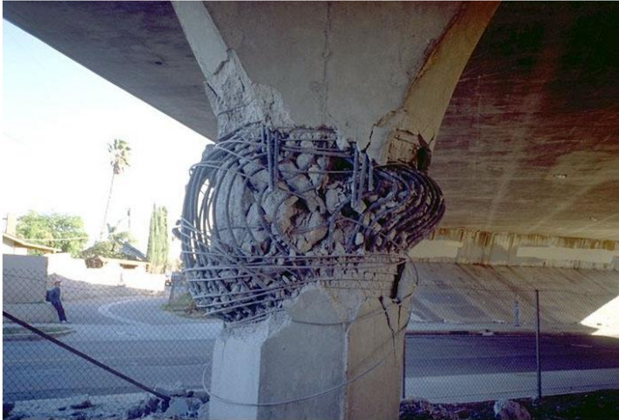
Σχήμα 4: Κατάρρευση υποστυλώματος λόγω του σεισμού Northridge στην Καλιφόρνια το 1994. ( http://umich.edu/~acemrl/NewFiles/projects/recc.html )
