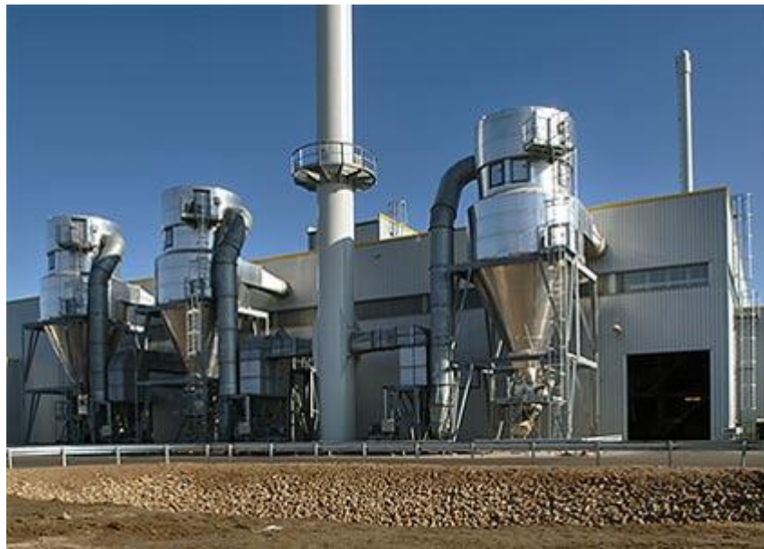
Εικόνα εργοστάσιου κομποστοποίησης Άνω Λιόσια.
