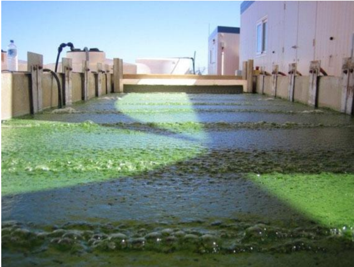
Εικόνα 16 Εγκατάσταση ηλεκτροσυσσωμάτωσης-πλεύσης σε δεξαμενή τύπου ανοιχτής λίμνης
