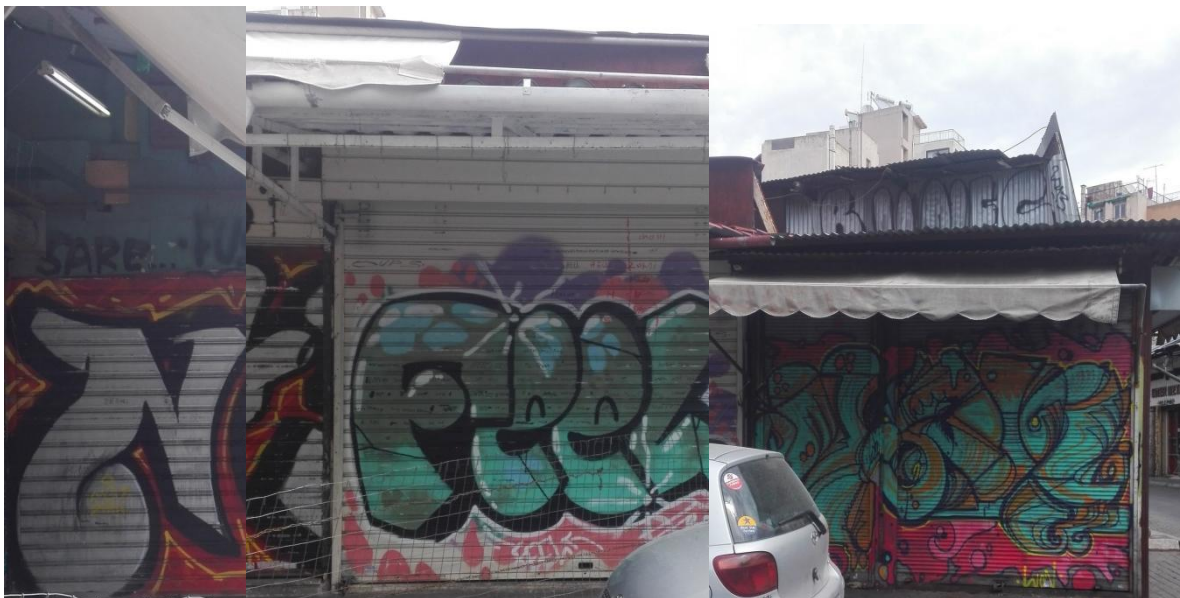
Εικόνα 28: Κολάζ φωτογραφιών που απεικονίζει τις φθορές που εντοπίζονται στη Βόρεια Όψη 3(εντός πλατείας)
