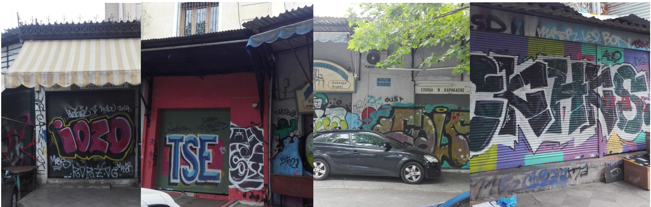
Εικόνα 34:Κολάζ φωτογραφιών για απεικόνιση των φθορών στην Ανατολική Όψη 2
