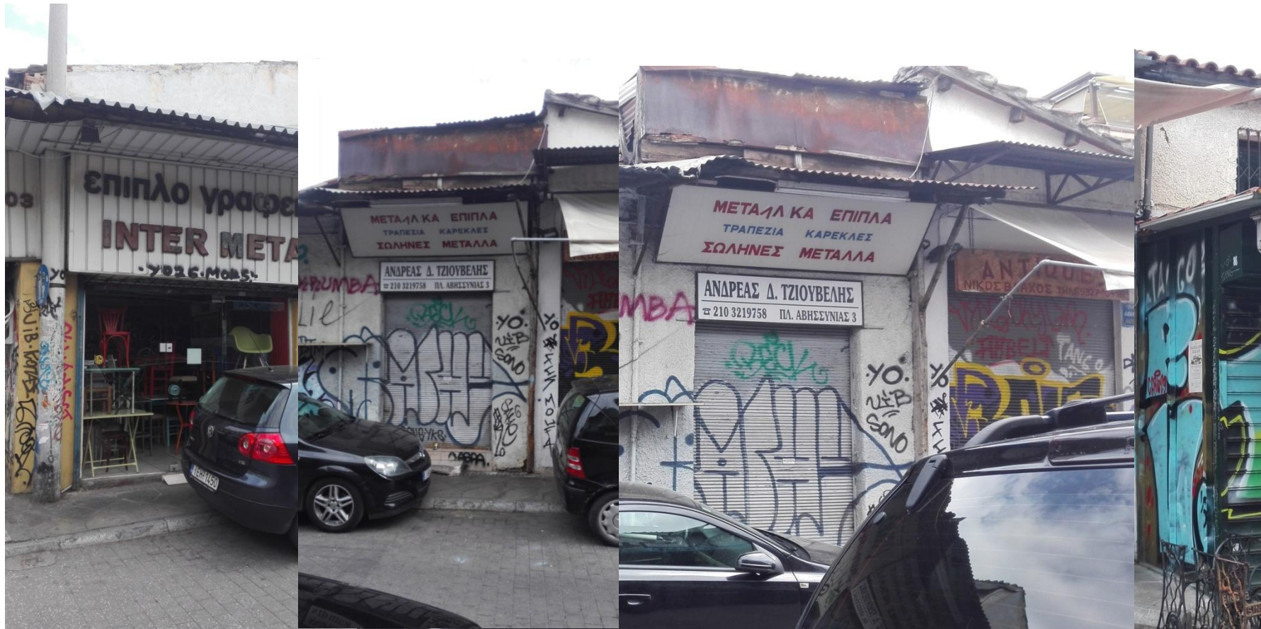
Εικόνα 27: Κολάζ φωτογραφιών που απεικονίζει τις φθορές που εντοπίζονται στην Ανατολική Όψη 3 (Είσοδος από Ερμού)
