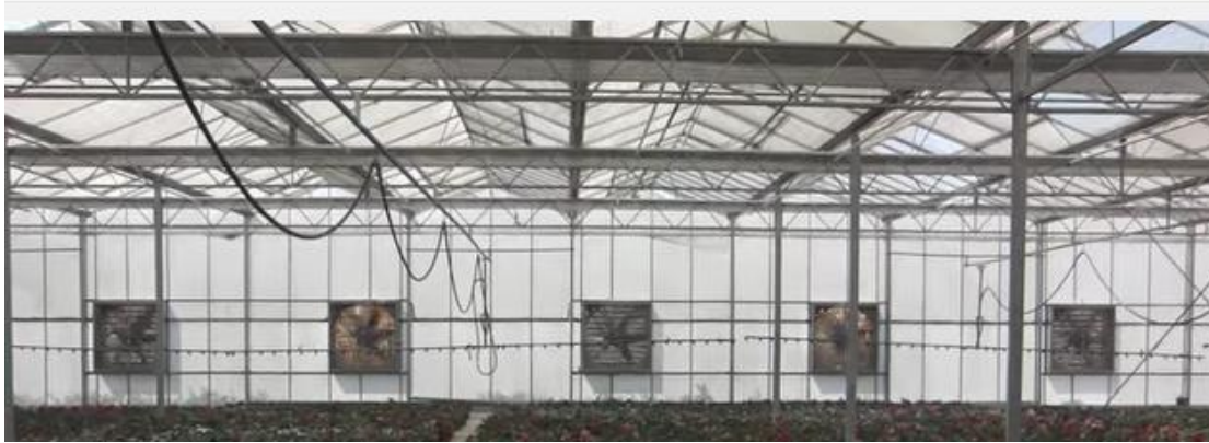
Σχήμα 5.1: Ανεμιστήρες για εξαερισμό του θερμοκηπίου
