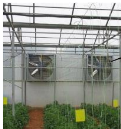
Σχήμα 5.4: Σύστημα δροσισμού με πάνελ.
