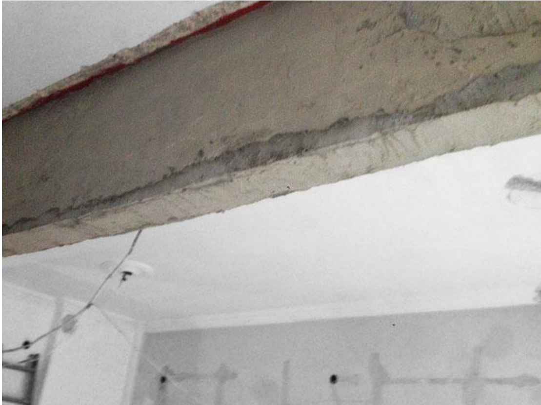
Σχήμα 1.6 Ρηγμάτωση στοιχείου σκυροδέματος [7].
