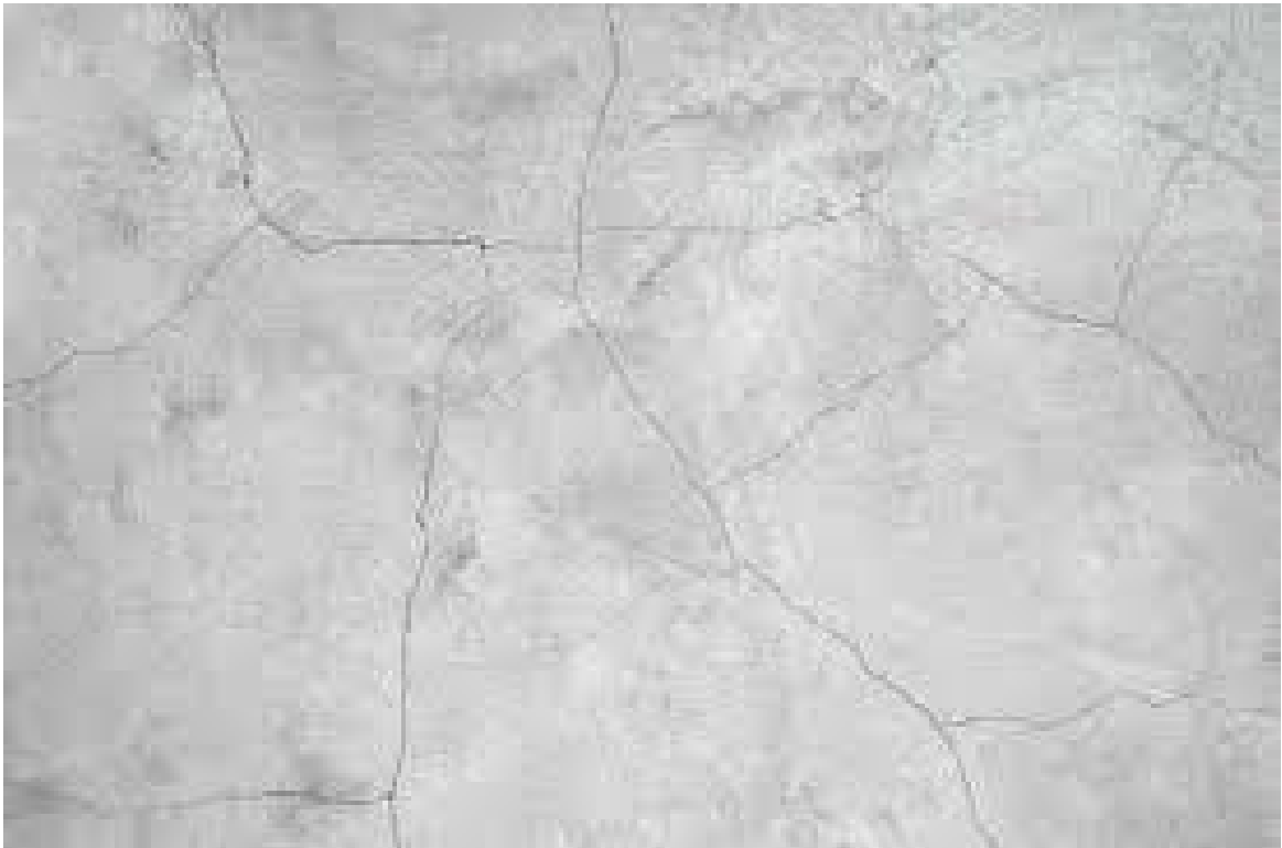
Σχήμα 1.2 Ρωγμές μικρού εύρους στην επιφάνεια μέλους από σκυρόδεμα [3].
