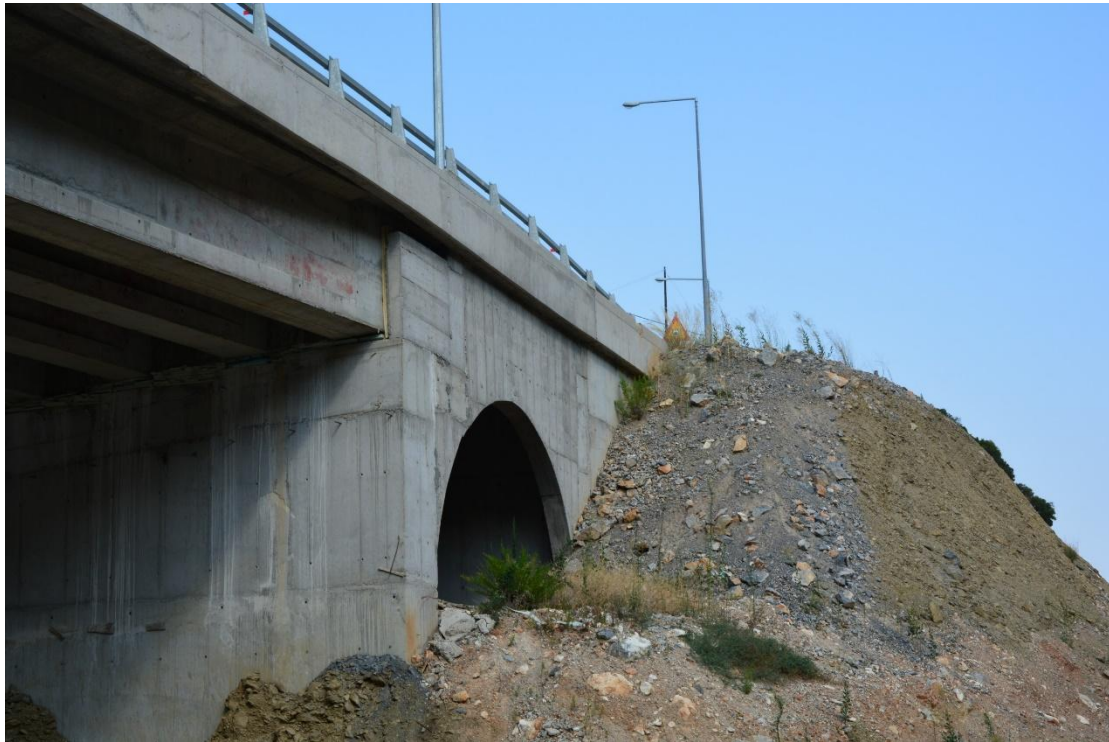
ΦΩΤ. 5.6 : Βορειοανατολική όψη του ακρόβαθρου A2 όπου διακρίνεται το μεσόβαθρο M2 και η θέση τοποθέτησης των ελαστομεταλλικών εφεδράνων.
