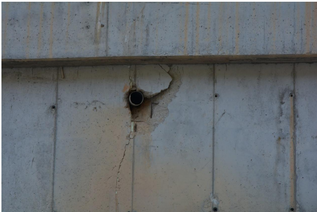
ΦΩΤ. 5.21 : Κατάληξη αγωγού όμβριων υδάτων.
