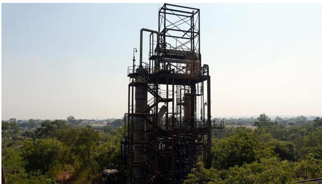
Ο πύργος πυρκαγιάς, στον οποίο απελευθερώθηκε στον αέρα το εξαιρετικά τοξικό αέριο ισοκυανικό μεθύλιο στην καταστροφή του 1984, στο εγκαταλειμμένο εργοστάσιο παραγωγής φωτοφαρμάκων Union Carbide στο Bhopal στις 28 Νοεμβρίου 2014 www.theatlantic.com
