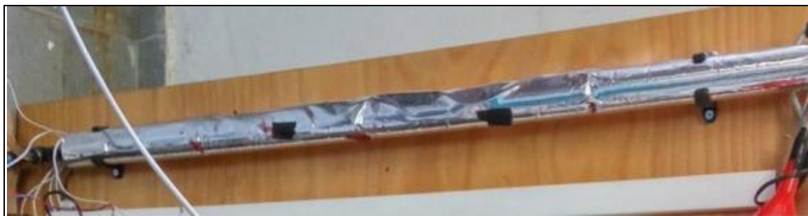
Εικόνα 3.3: Σωλήνας μήκους 1m τυλιγμένος με μονωτικό υλικό.
