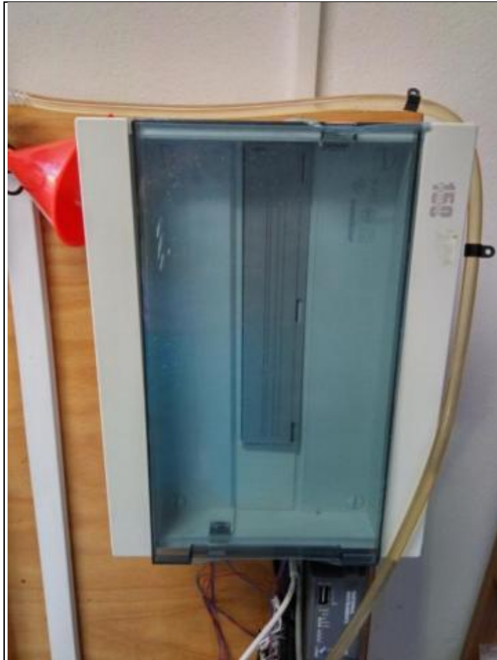
Εικόνα 3.5: Πίνακας που περιέχει τα τροφοδοτικά της πειραματικής εγκατάστασης.
