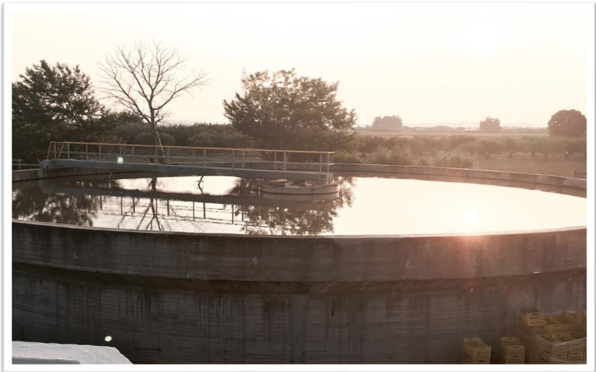
Εικόνα 17: Δεξαμενή Καθίζησης Α
