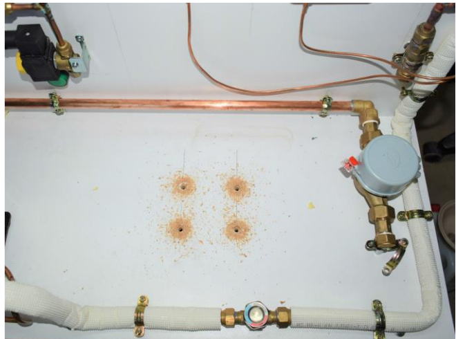
Εικόνα 2.40: Σημείο Τοποθέτησης Εξατμιστή Νερού
