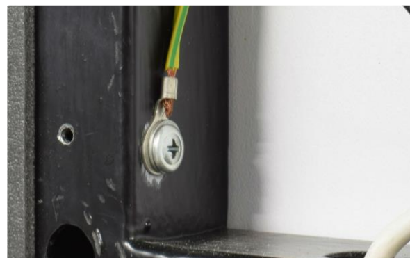
Εικόνα 3.35: Γείωση Μεταλλικού Σκελετού
