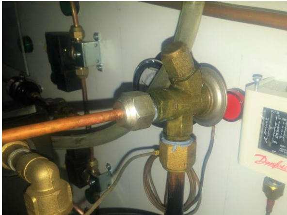
Εικόνα 2.42: Τοποθετημένη Θερμοεκτονωτική Βαλβίδα
