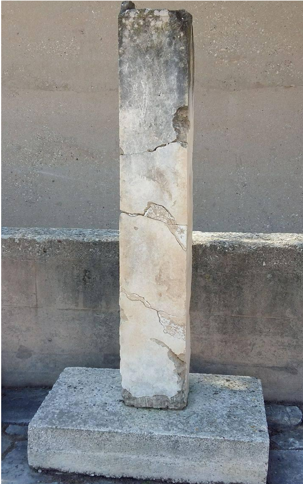
Εικόνα 5.3.1.β. Στην παραπάνω κολώνα παρατηρούμε πάνω από μία ρωγμές σε διάφορα σημεία της.
