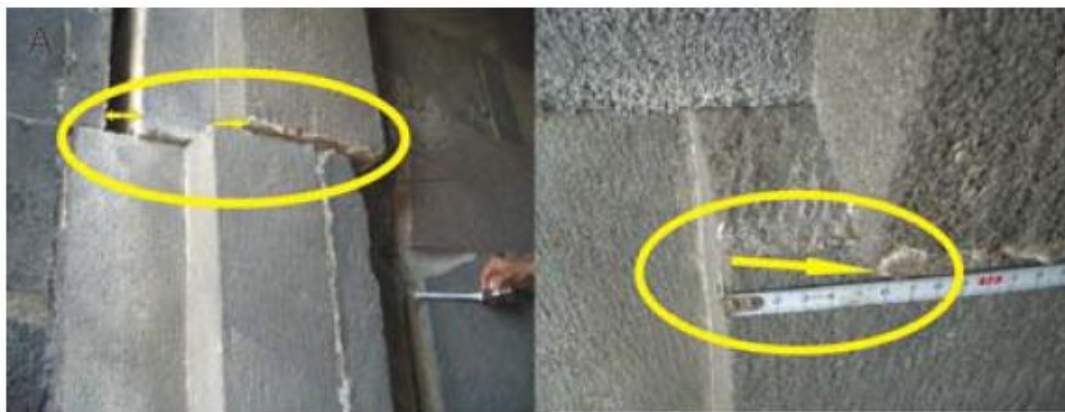
Εικόνα 3.2.3. Ναός Shiva: Μετατόπιση 45 χιλιοστά και στροφή 20 °.
