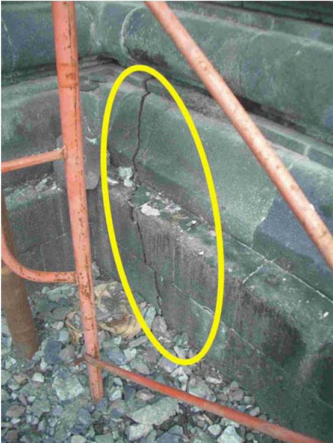
Εικόνα 3.2.5. Ναός Brahma: ένα οριζόντιο πλευρικό σφάλμα στην αριστερή Βορειοδυτική πλευρά του ναού. Το επίπεδο κάτω από αυτό τον όροφο περιβάλλεται από έναν ενισχυμένο τσιμεντένιο τοίχο. Υπέστη 4 χιλιοστά αριστερή πλευρική μετατόπιση.
