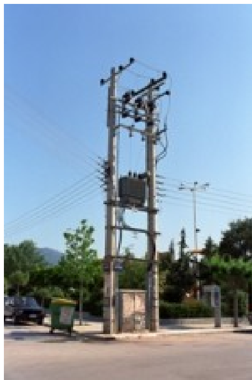
Εικόνα 1.10: Εναέριος υποσταθμός διανομής μέσης τάσης σε χαμηλή.
