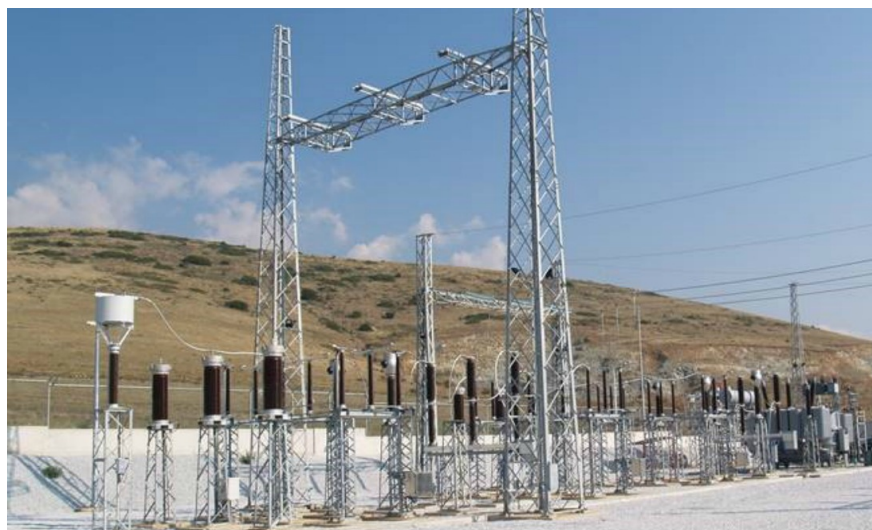
Εικόνα 1.9: Υποσταθμούς ανύψωσης και υποβιβασμού υψηλής τάσης
