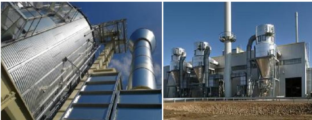
Εικόνα 3.1: Εγκαταστάσεις επεξεργασίας βιομάζας.
