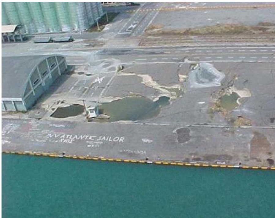
Εικόνα 4.3 Παραμόρφωση του εδάφους λόγω ρευστοποίησης σε επίστρωση από ασφάλτο πίσω από κρηπιδότοιχο στο λιμάνι Taichung κατά την διάρκεια του σεισμού του Chi-Chi.
