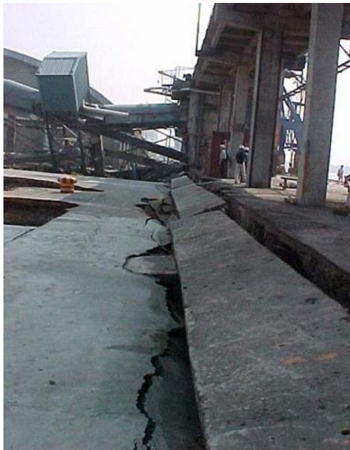
Εικόνα 4.5 Καθίζηση πίσω από κρηπιδότοιχο διατομής κιβωτίου που υπέστη πλευρική μετακίνηση στο λιμάνι Taichung κατά την διάρκεια του σεισμού του Chi-Chi.
