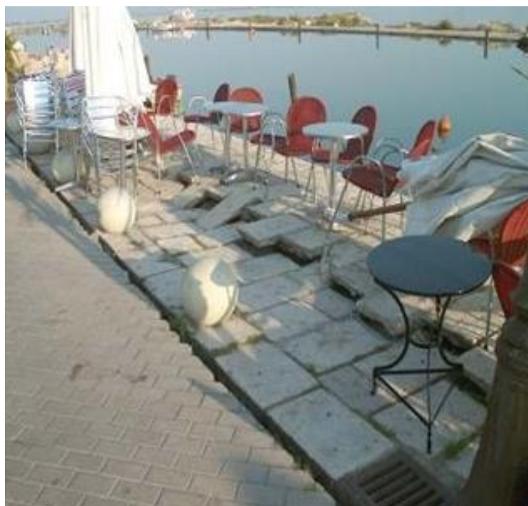
Εικόνα 9. Καθίζηση του επιχώματος πίσω από κρηπιδότοιχο και βλάβες στην ποδιά του πεζοδρομίου στην πόλη της Λευκάδας στον σεισμό του 2003.
