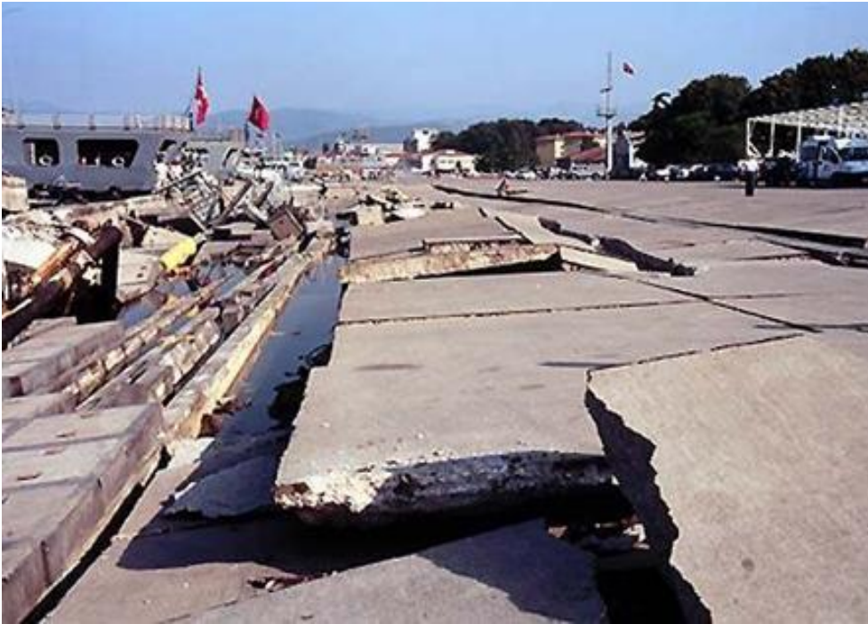
Εικόνα 4.1 Κατεστραμμένοι κρηπιδότοιχοι στην ναυτική βάση του Golcük κατά την διάρκεια του σεισμού του Kocaeli.
