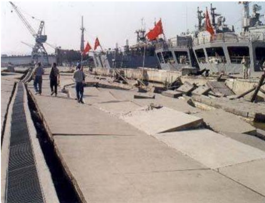
Εικόνα 4.2 Κατεστραμμένοι κρηπιδότοιχοι στην ναυτική βάση του Golcük
