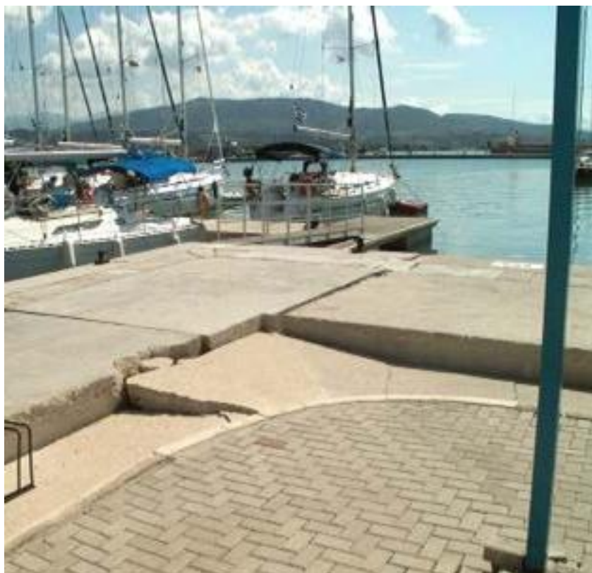
Εικόνα 8. Καθίζηση επιχώματος (25cm), ολίσθηση προς την θάλασσα και στροφή κρηπιδότοιχων στην Μαρίνα της Λευκάδας στον σεισμό του 2003.
