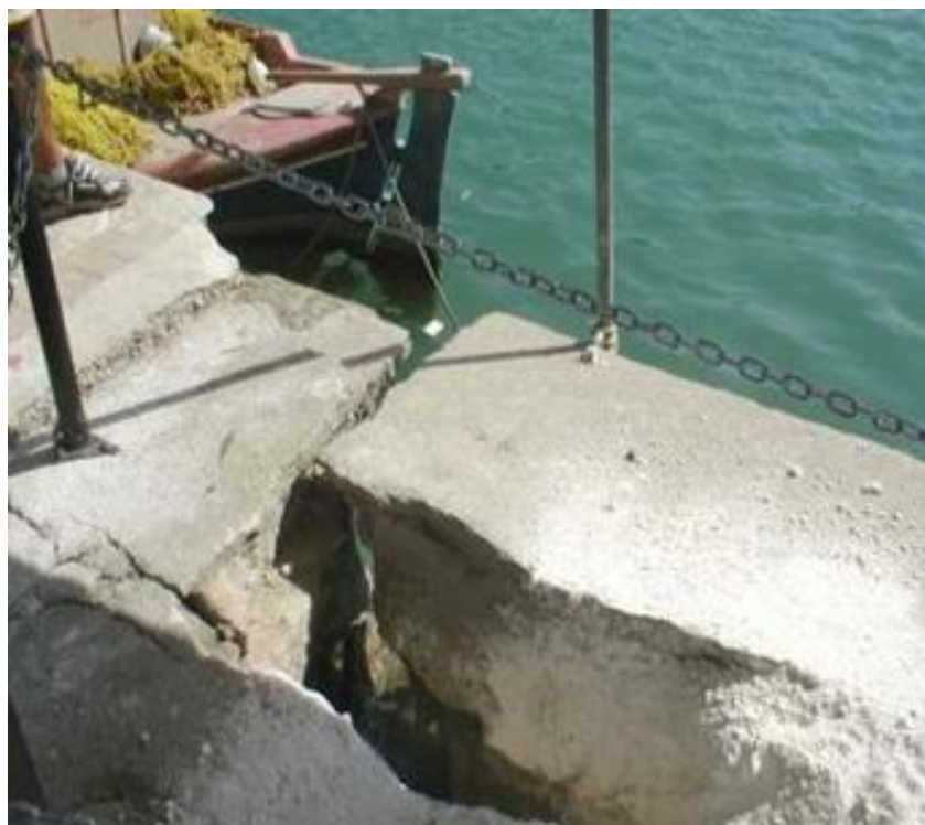
Εικόνα 6. Οριζόντια ολίσθηση κρηπιδότοιχου ίση με 45cm στο λιμάνι της Βασιλικής στον σεισμό της Λευκάδας.
