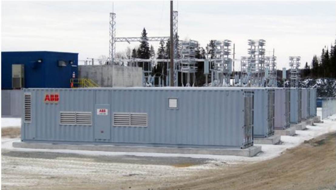
Εικόνα 23: Μονάδες STATCOM της εταιρείας ABB
