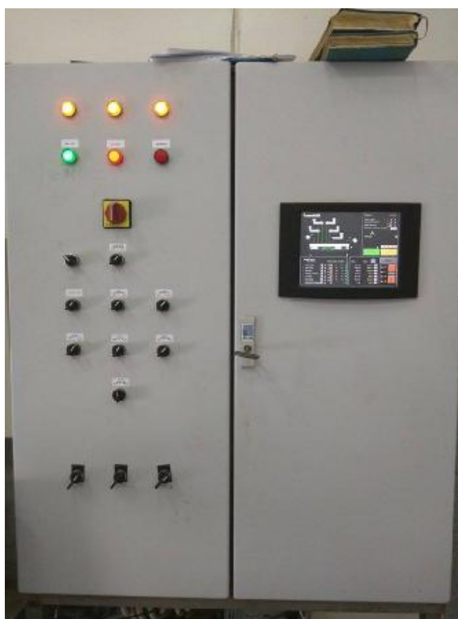
Εικόνα 56: Ο πίνακας διανομής της εγκατάστασης
