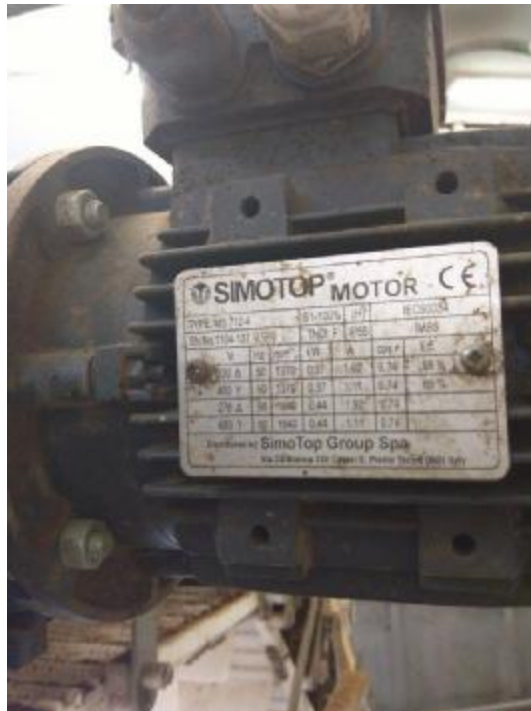
Εικόνα 54: Η πινακίδα ενός κινητήρα της προς μελέτη εγκατάστασης
