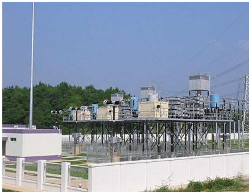
Εικόνα27: Μια εγκατάσταση TCSC
