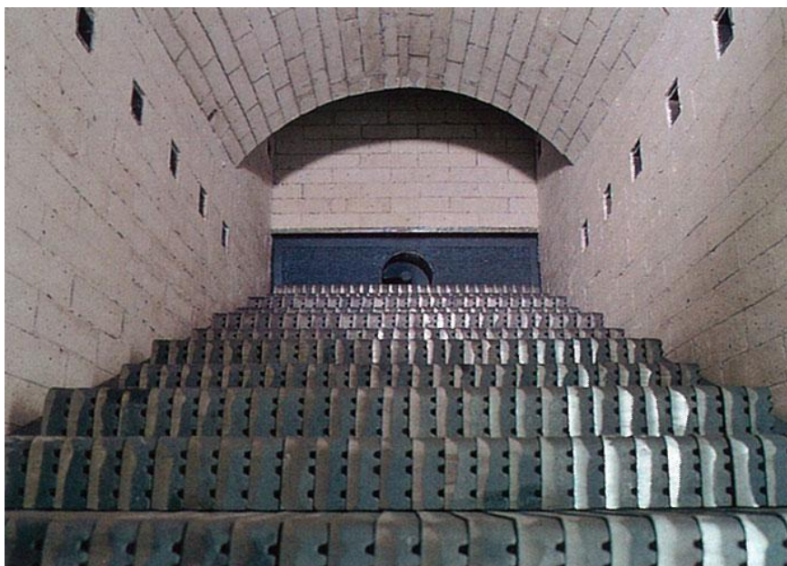
Εσωτερικό θαλάμου καύσης με κινούμενες εσχάρες
