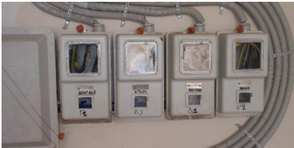
Εικόνα 0.1: Μετρητές Ηλεκτρικής Ενέργειας
