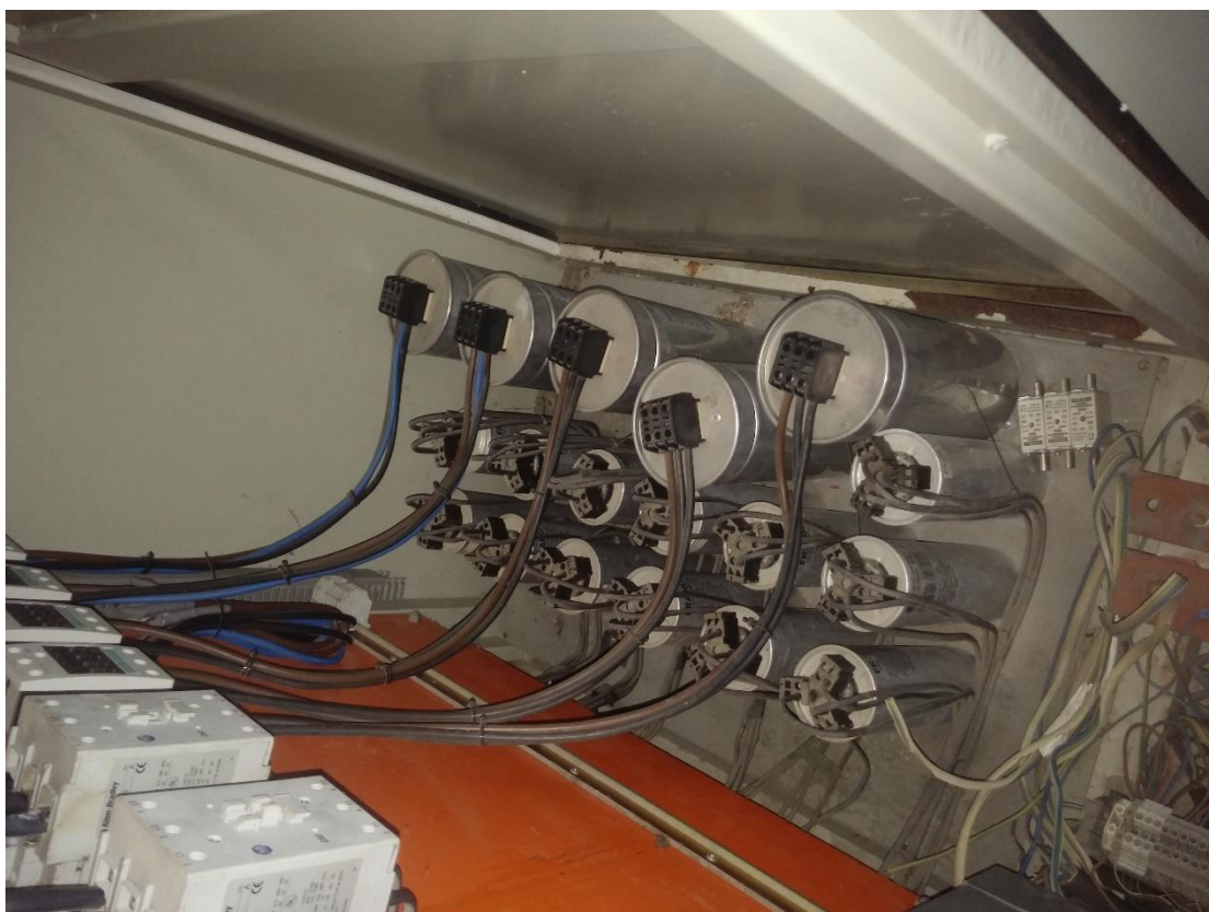
Εικόνα 5.2 : Πυκνωτές για παραγωγή το Qc στην εγκατάσταση
