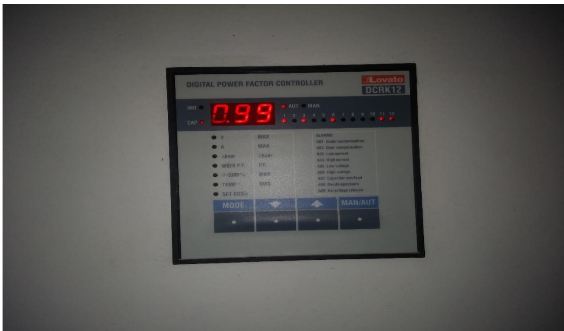
Εικόνα 5.1: Μετρητής τελική κατάσταση
