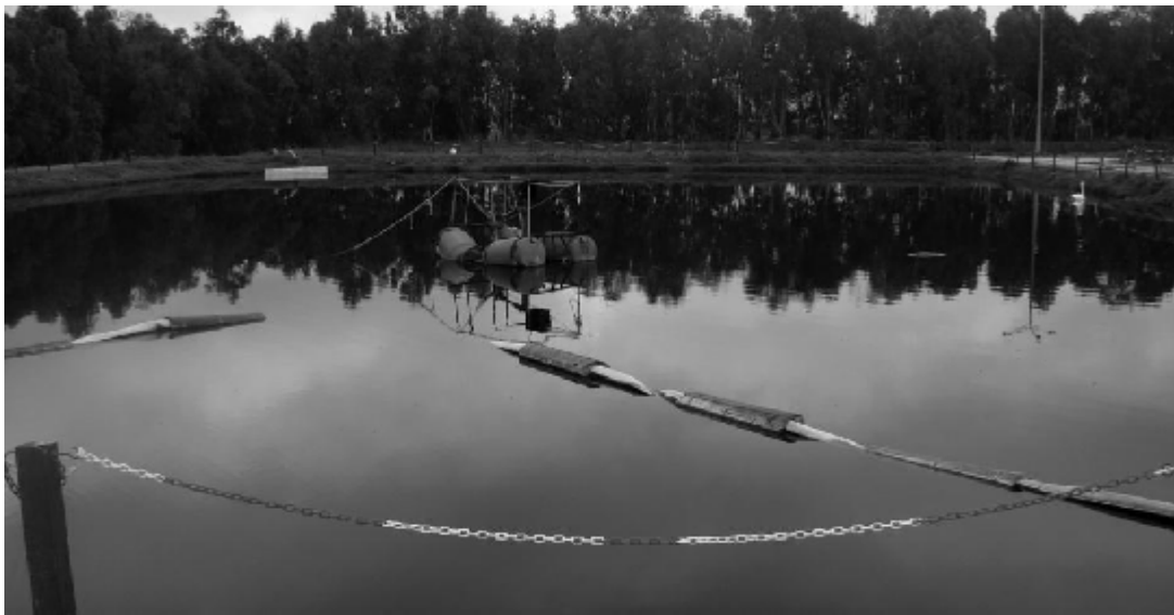
Εικόνα 4.8: Δεξαμενή ήπιου αερισμού [12].
