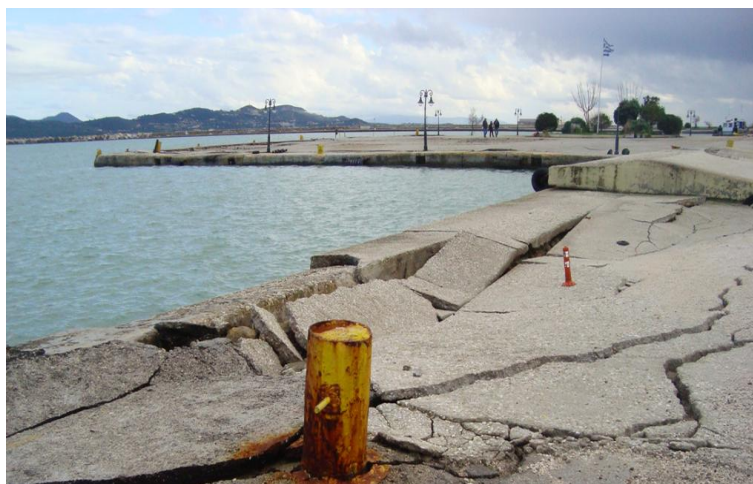
Εικόνα 3.24: Καθίζηση κρηπιδότοιχου στο λιμένα
