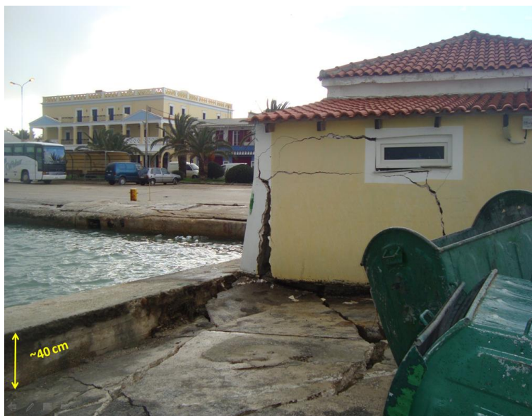
Εικόνα 3.27: Εδαφική αστοχία-καθίζηση 40 cm
