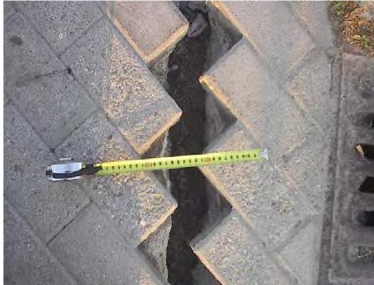
Εικόνα 3.7: Λευκάδα - Οδ. Σικελιανού: Οριζόντια μετακίνηση 10 όπισθεν του κρηπιδότοιχου
