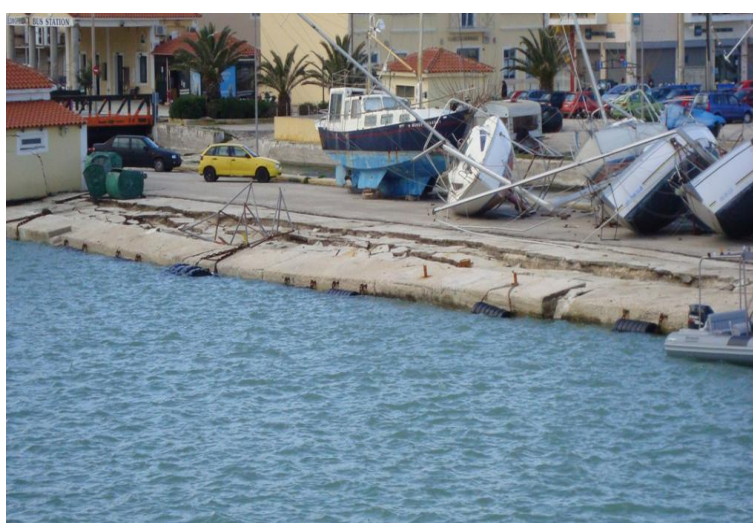
Εικόνα 3.23: Αστοχία κρηπιδότοιχου στο λιμένα
