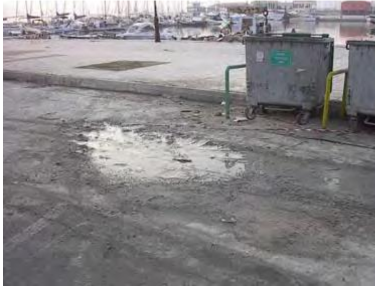
Εικόνα 3.1: Λευκάδα – Οδ. Γκολέμη: Ρευστοποίηση εδάφους με ανάδυση λεπτόκοκκου υλικού.
