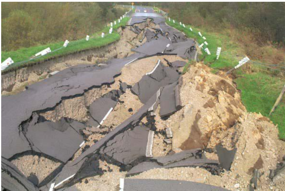
Εικόνα 2.5 Καθίζηση από ρευστοποίηση
