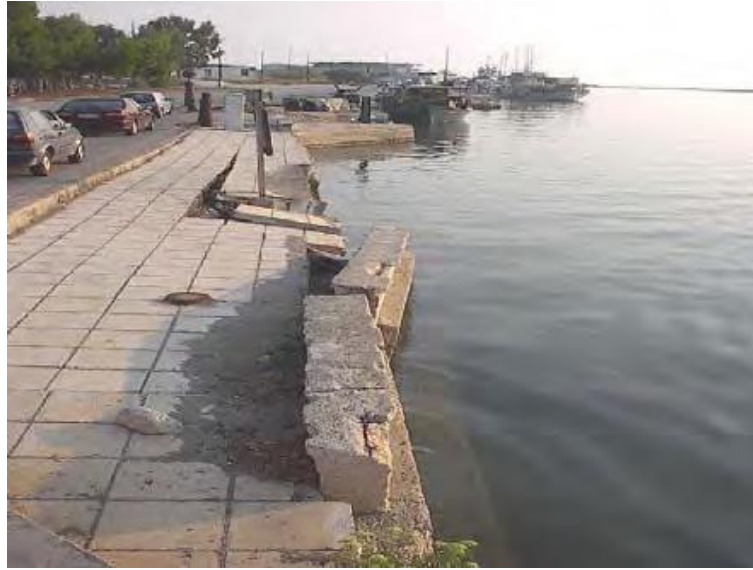
Εικόνα 3.3: Λευκάδα – Είσοδος (βορείως της πλωτής γέφυρας): Αστοχία κρηπιδώματος.
