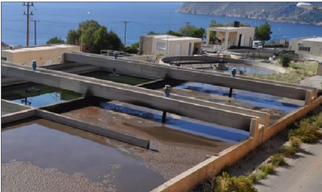
Εικόνα: Δεξαμενή αερισμού
