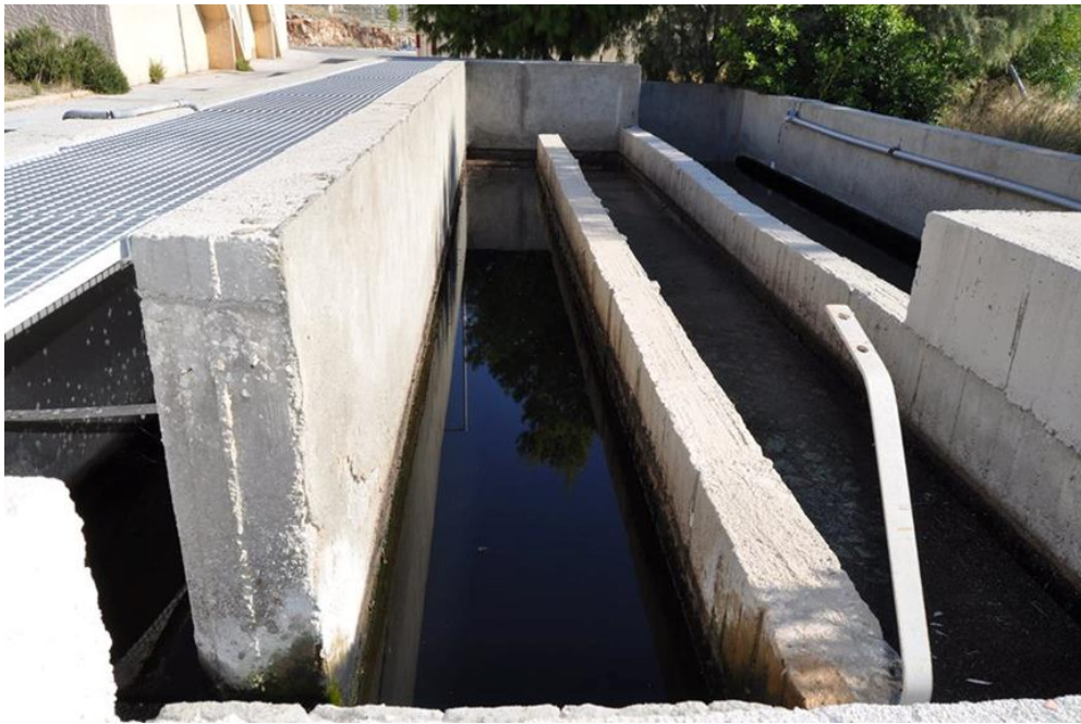
Εικόνα: Λύματα που οδηγούνται στην δεξαμενή χλωρίωσης με εμφανή τα θυροφράγματα (μυαιανδρικού τύπου)
