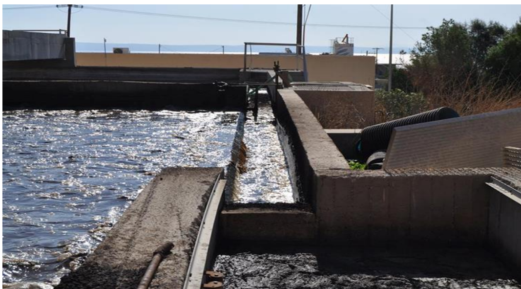
Εικόνα: Υπερχείλιση υγρού από δεξαμενή αερισμού
