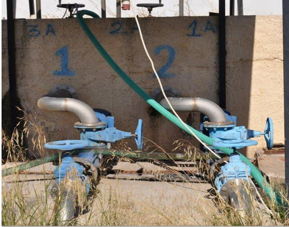
Εικόνα: Αντλίες ανακυκλοφορίας ιλύος (1,2,3 A) και περίσσειας ιλύος (1,2)
