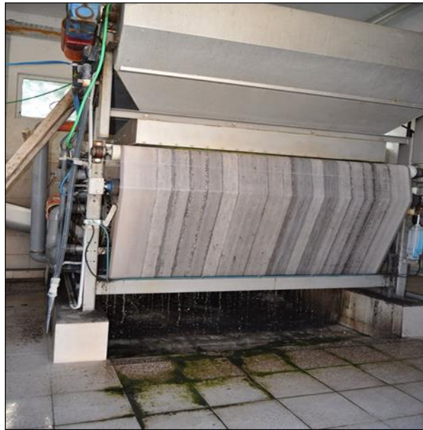
Εικόνα: Μονάδα έκπλυσης άμμου - Αφαίρεση οργανικών στοιχείων
