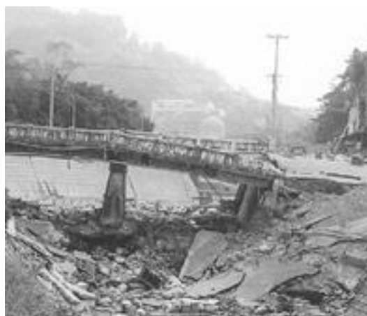
Σχήμα 2.4: Αστοχία ακρόβαθρου λόγω ρευστοποίησης εδάφους θεμελίωσης.
