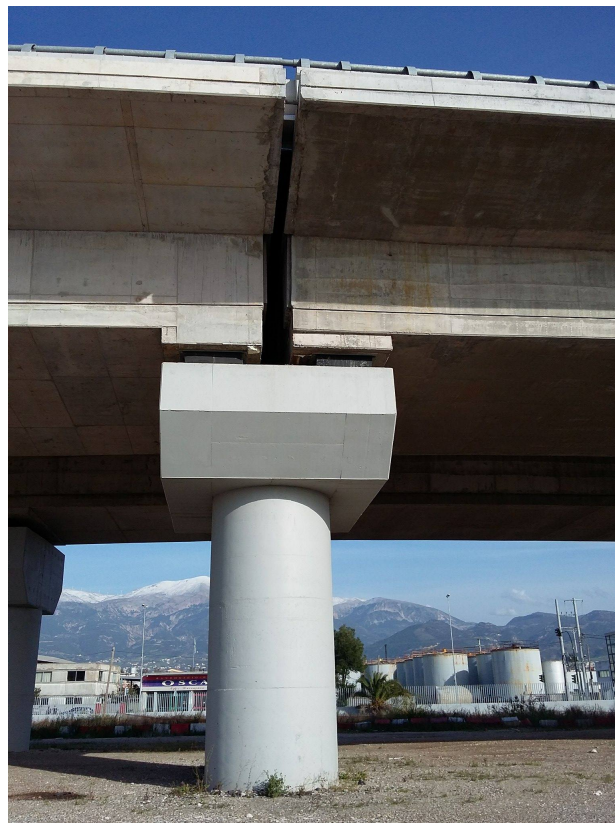
Φωτ. 6.7: Δυτική όψη του μεσόβαθρου Μ5.Δ με ύψος 8,40 m.Αριστερά φαίνεται η παρούσα γέφυρα Τ1 και δεξιά η Τ2.
