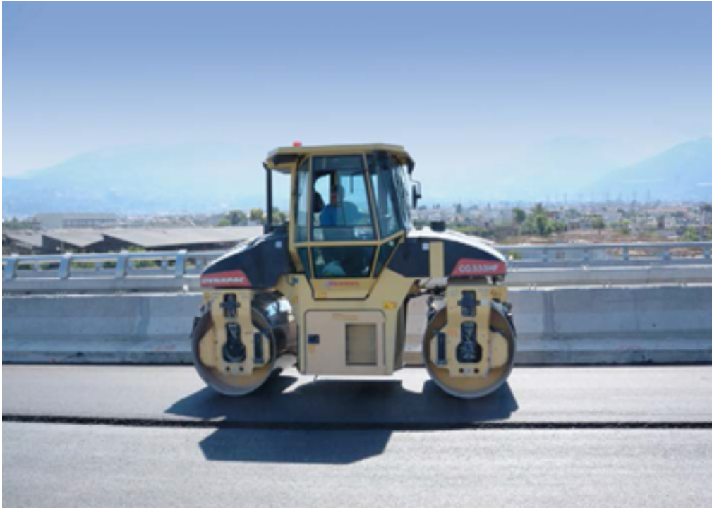
Φωτ. 6.10: Οδοστρωτήρας με δύο κυλίνδρους κατά τη διάρκεια συμπύκνωσης της ασφαλτικής στρώσης.
