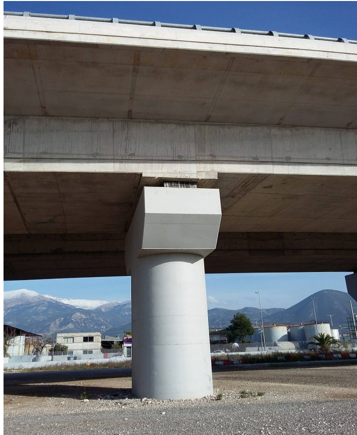
Φωτ. 6.4: Δυτική όψη μεσοβάθρου M2.Δ (αποτελείται από ένα σύλο και έχει ορθογωνική διατομή με ημικυκλικά άκρα με εξωτερικές διαστάσεις 2.5m x 4.0m) και ελαστομεταλλικά εφέδρανα.
