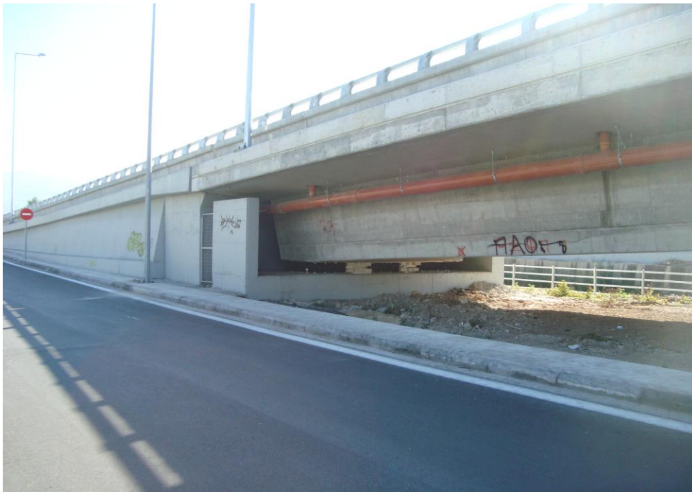
Φωτ. 6.4: Νοτιοανατολική όψη ακροβάθρου A2.A σε πρώτο πλάνο και θέσεις τοποθέτησης εφεδράνων.
