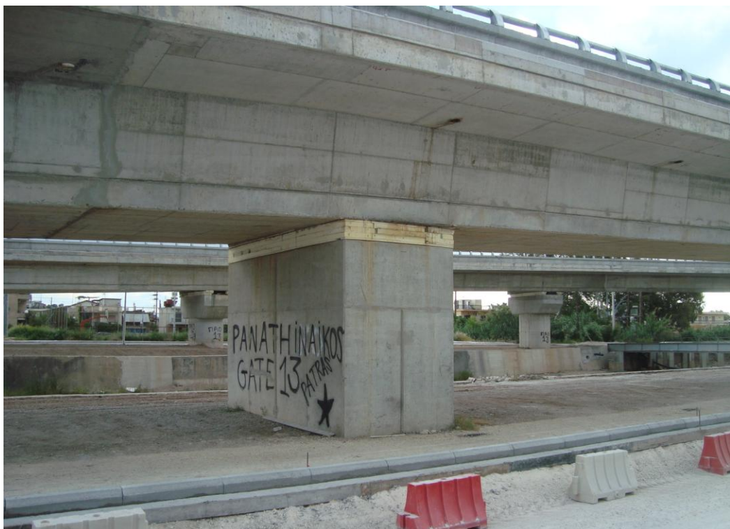
Φωτ. 6.9: Μεσόβαθρο M16.A ορθογωνικής διατομής και θέσεις τοποθέτησης εφεδράνων στη παρούσα γέφυρα T10.
