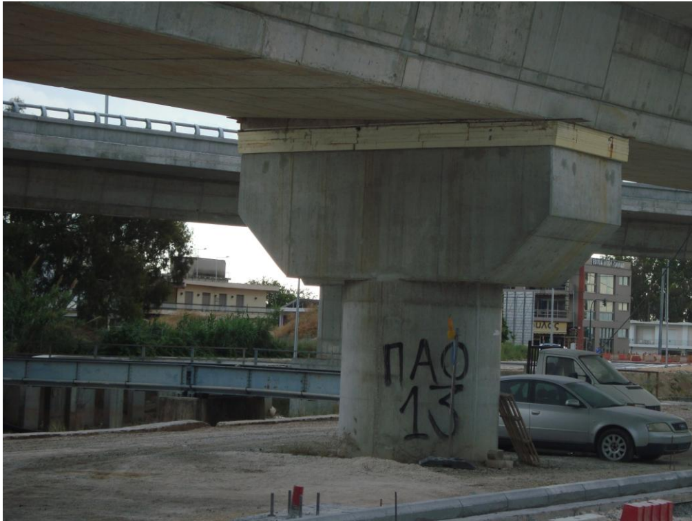
Φωτ. 6.12: Νοτιοδυτική όψη μεσόβαθρου Μ15.Α κυκλικής διατομής διαμέτρου 2,5m και θέσεις τοποθέτησης εφεδράνων.
