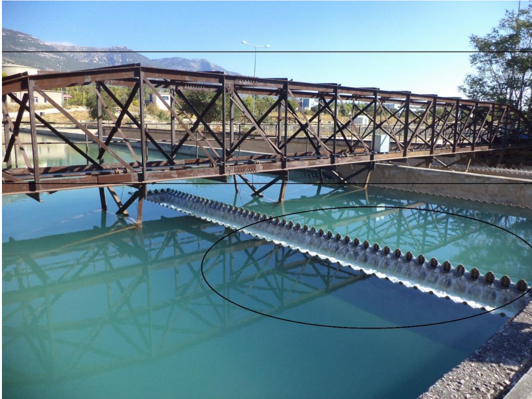
Εικόνα 5-10. Ορθογώνια δεξαμενή όπου είναι ορατοί οι υπερχειλιστές και η γερανογέφυρα. Έχουμε μια γερανογέφυρα ανά δυο δεξαμενές καθίζησης.
