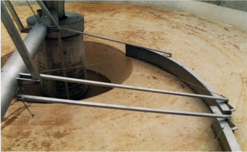
Εικόνα 5-21. Είσοδος κώνου συγκέντρωσης ιλύος και (σάρωτρο) ξέστρο πυθμένα
