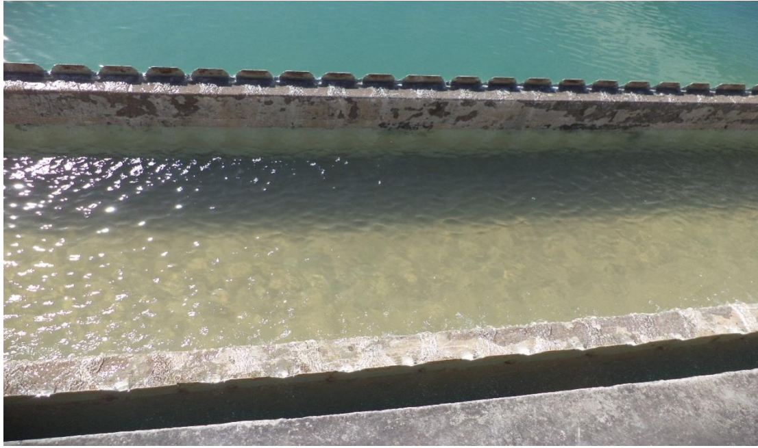
Εικόνα 5-17. Υπερχειλιστής. Στις κυκλικές δεξαμενές οι υπερχειλιστές βρίσκονται εξωτερική επιφάνεια της δεξαμενής
