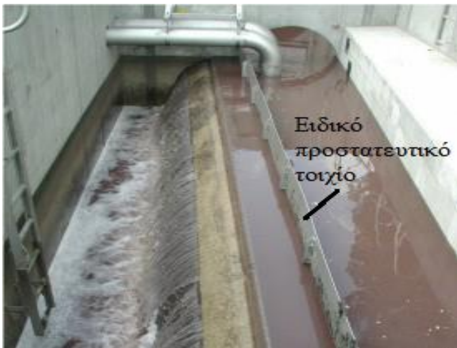
Εικόνα 4-5. Ειδικό προστατευτικό τοιχίο για την προστασία της εκροής από την δεξαμενή καθίζησης 77
