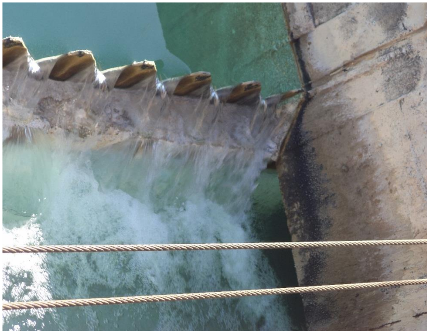
Εικόνα 5-8 και Εικόνα 5-9 Υπερχειλιστές δεξαμενών καθίζησης
