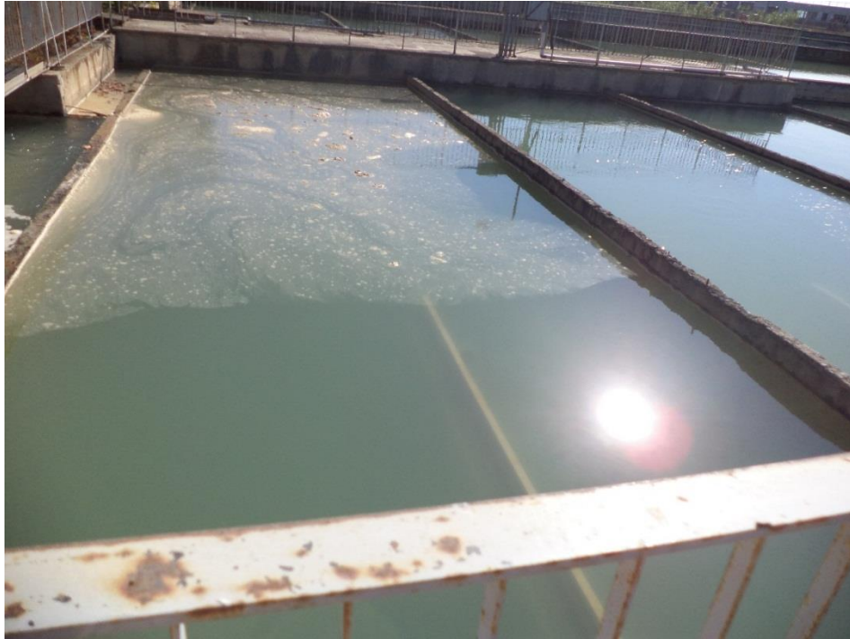
Εικόνα 5-2. Βρισκόμαστε σε πρώτο στάδιο της επεξεργασίας όπου το νερό έχει εισέλθει στην δεξαμενή, έχουμε κάνει ρίψη κροκιδωτικών, πολυηλεκτρολύτης και θειικό αργίλιο, και με την βοήθεια των αναδευτήρων η ιλύς και τα άλλα απόβλητα σιγά σιγά αρχίζουν να καθιζάνουν. Η θολότητα είναι μεγάλη.
