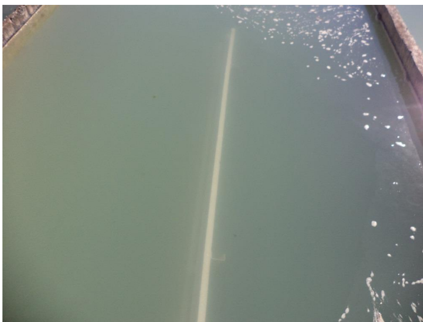
Εικόνα 5-5. Αναδευτήρας της δεξαμενής καθίζησης
