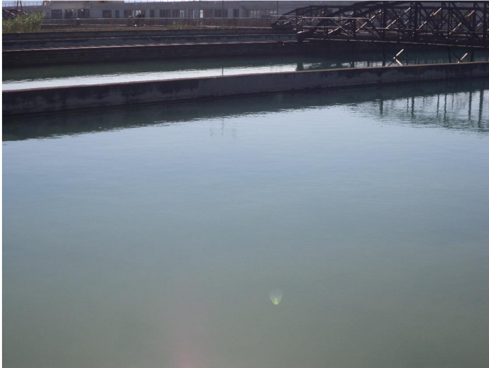
Εικόνα 5-6. Βρισκόμαστε προς το τέλος της δεξαμενής και το νερό έχει καθαρίσει σε μεγάλο βαθμό, απομακρύνοντας την θολότητα και τα διάφορα απόβλητα που υπήρχαν
