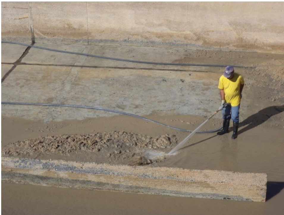
Εικόνα 5-14. Υπάλληλος της ΜΕΝ Μενιδίου καθαρίζει την ιλύ και τα διάφορα απορρίμματα που έχουν καθιζάνει στον πυθμένα της δεξαμενής.
